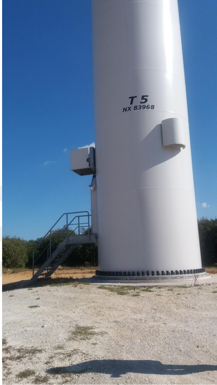
Şekil 4.5. Beşiktepe rüzgar enerji santrali T-5 türbininden bir görünüm
