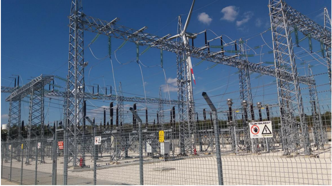
Şekil 4.3. Beşiktepe rüzgar enerji santralinin şalt sahasından bir görünüm
