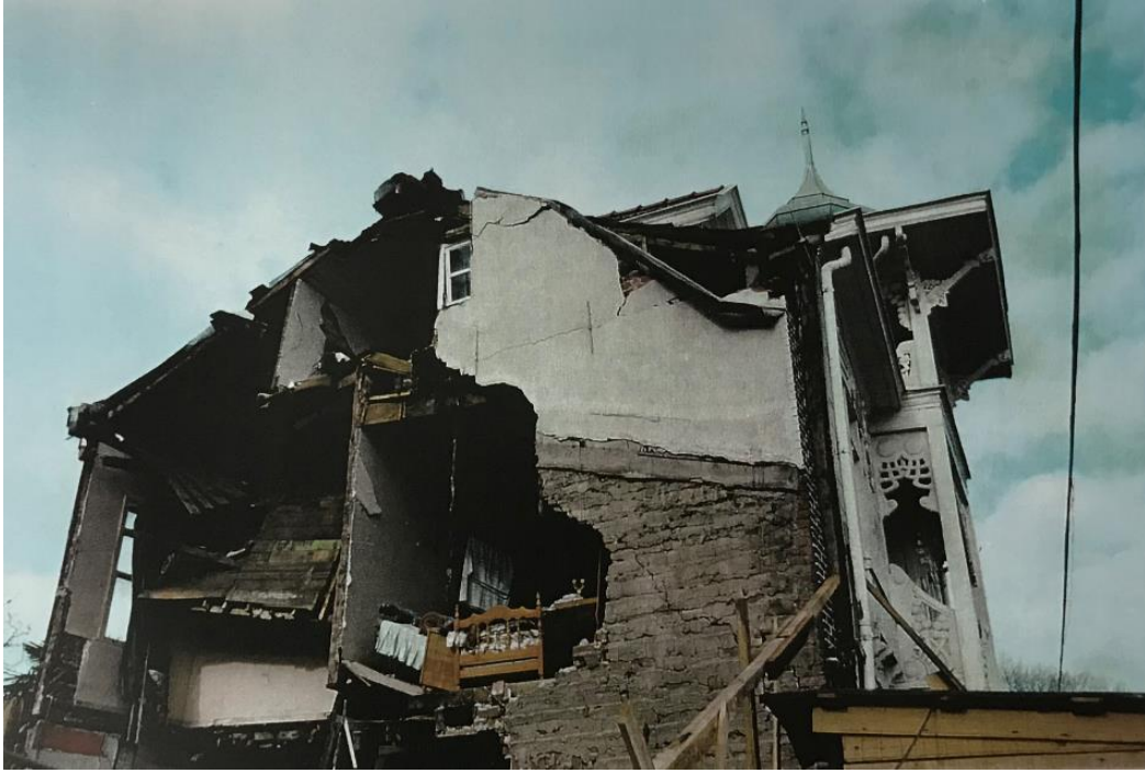
Şekil 5. 132: Dikranyan Yalısı, 1992 yılında yan parseldeki inşaat sırasında yıkılan yangın duvarı
