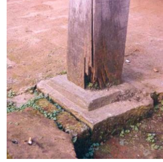
Şekil 193. Zeminde Çürüme Ve Çatlama [224]
