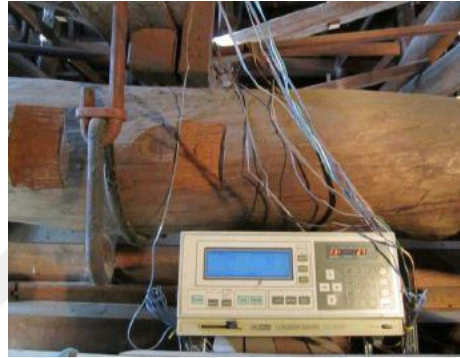
Şekil 203. Taşıyıcılarda Oluşan Gerilimin Ölçülmesi [229]
