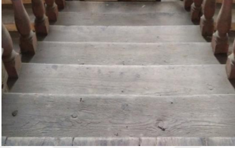
Şekil 519. Merdiven Kaplaması Aşınması [168]
