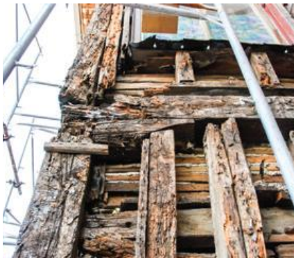
Şekil 245. Ahşap İskeletteki Hasarlar [249]
