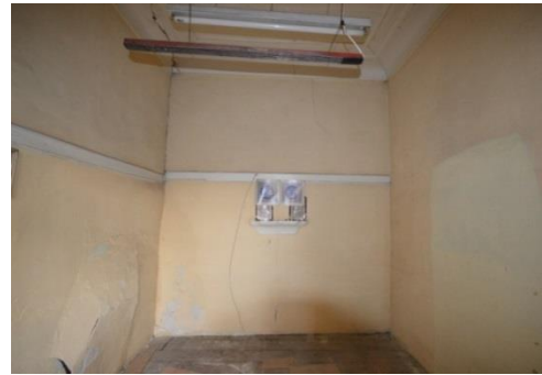
Şekil 518. Tesisat Kaynaklı Bozulma [265, 281]
