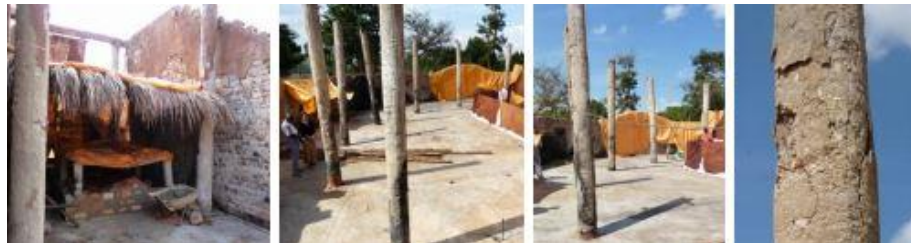
Şekil 229. Önceki Güçlendirme Çalışmalarından Kalan Betonarme Kolonlar [240]
