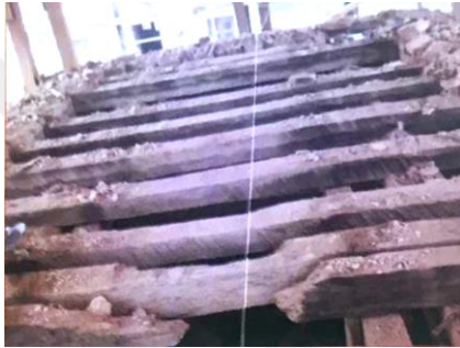
Şekil 194. Depremde Hasar Gören Taşıyıcılar [225]
