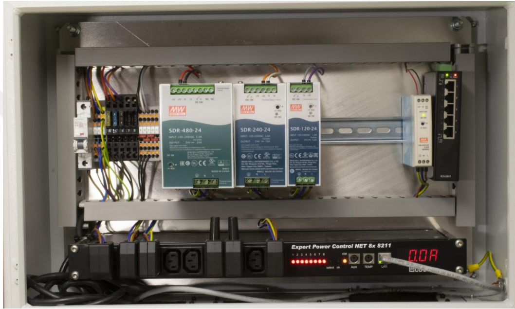
Şekil 3.45 Teleskop elektrik panosu
