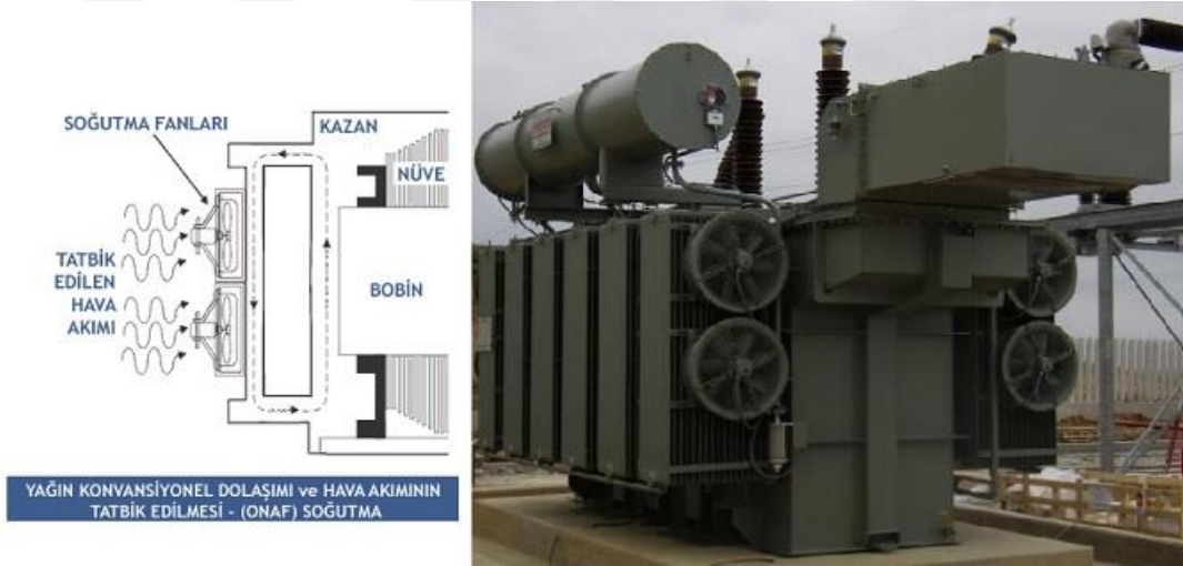
Şekil 2.15: ONAF soğutmalı trafo
