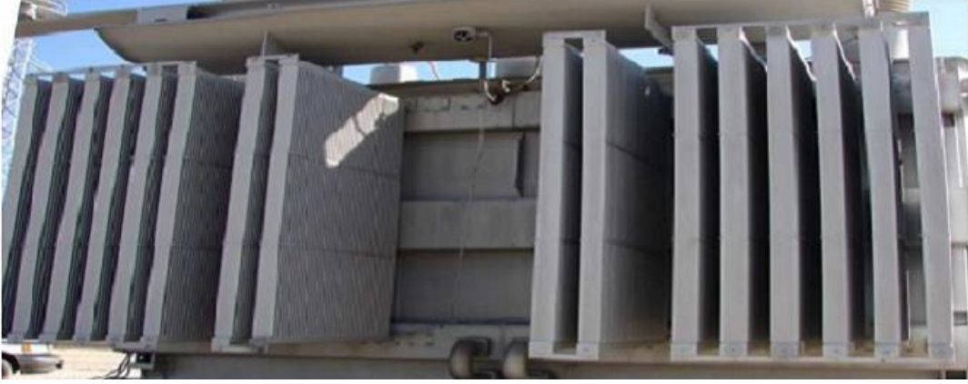
Şekil 2.17: OFWF soğutmalı trafo
