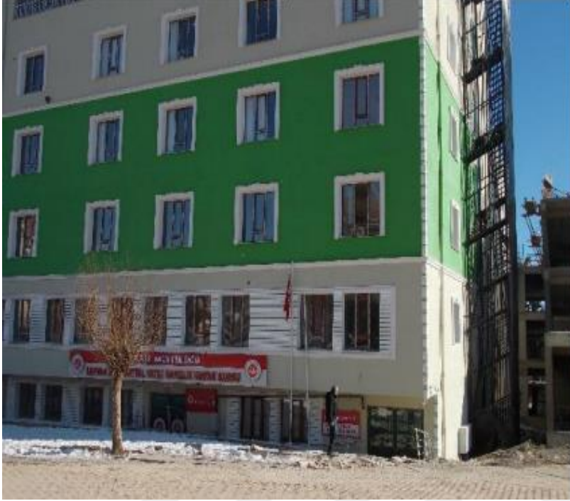
Resim 2.5. Sıvılaşma sonucu bir üstyapının zemin içine batması ( Ülgen ve ark., 2023).
