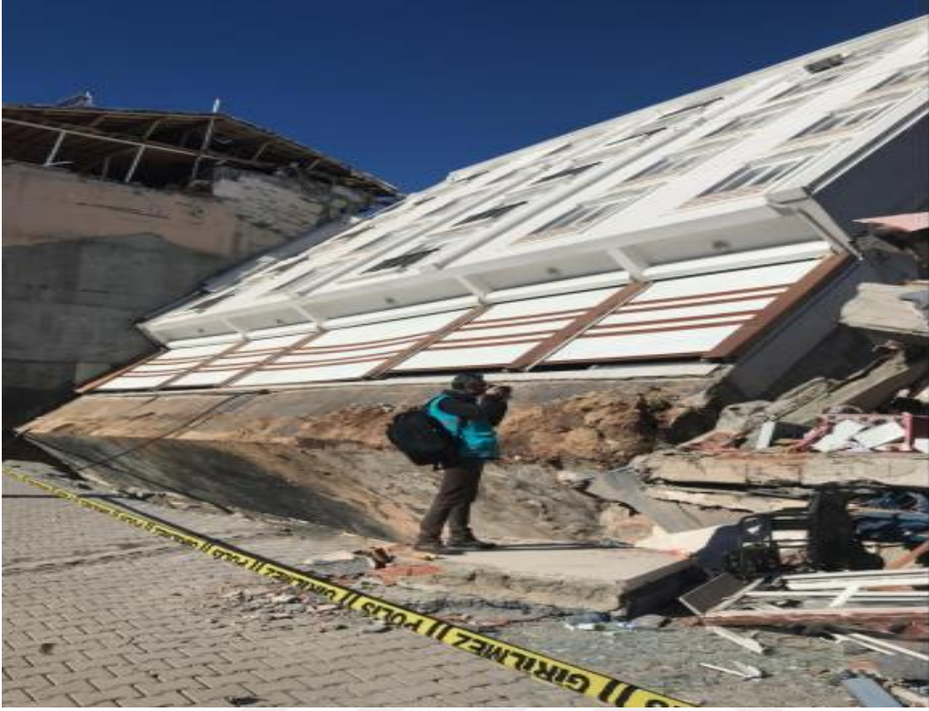
Resim 2.1. Gölbaşı ilçesinde sıvılaşma sonucunda devrilen bir bina (Çağlar ve ark., 2023).
