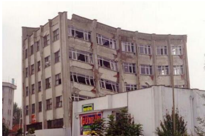
Şekil 3.4 Burulma düzensizliğine bağlı hasar oluşumu (Çağatay vd., 2012)
