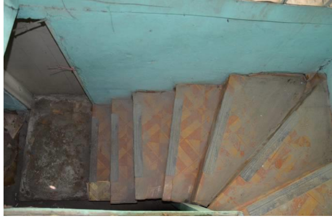
Şekil 3.23: 2704 Ada 15-16 Parsel No.lu Konutun Restore Edilmeden Önce Z02-1 Avlu Mekanında Bulunan Merdiven
