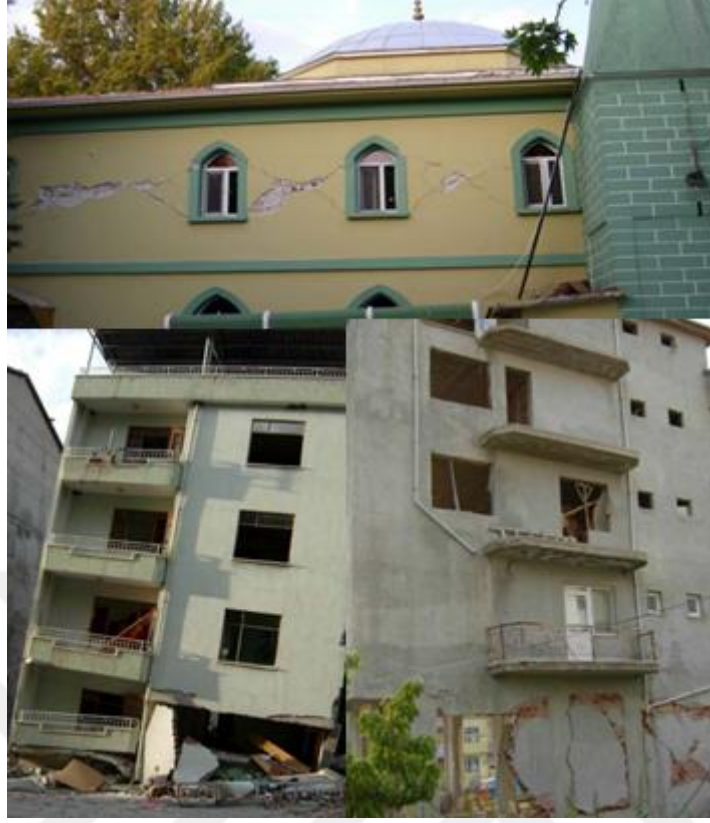
Şekil 6.22 2011 Simav Depremi sonucunda bazı yapılarda meydana gelen hasarlar (İnt. Kyn. 9).
