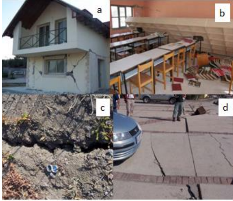
Şekil 6.21 17-21 Ekim 2005 tarihlerinde Sığacık Körfezi'nde gerçekleşen depremlerin etkileri (a,b: makaslanmış ve yıkılmış duvarlar, c:deprem sırasında meydana gelen kuzey-güney uzanımlı çatlaklar, d: Sığacık Limanı'nda meydana gelen çökme ve yükselmeler), (Sözbilir vd. 2009).
