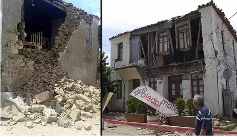
Şekil 6.23 2014 Gökçeada depremi sonucunda bazı yapılarda meydana gelen hasarlar (İnt. Kyn. 12).
