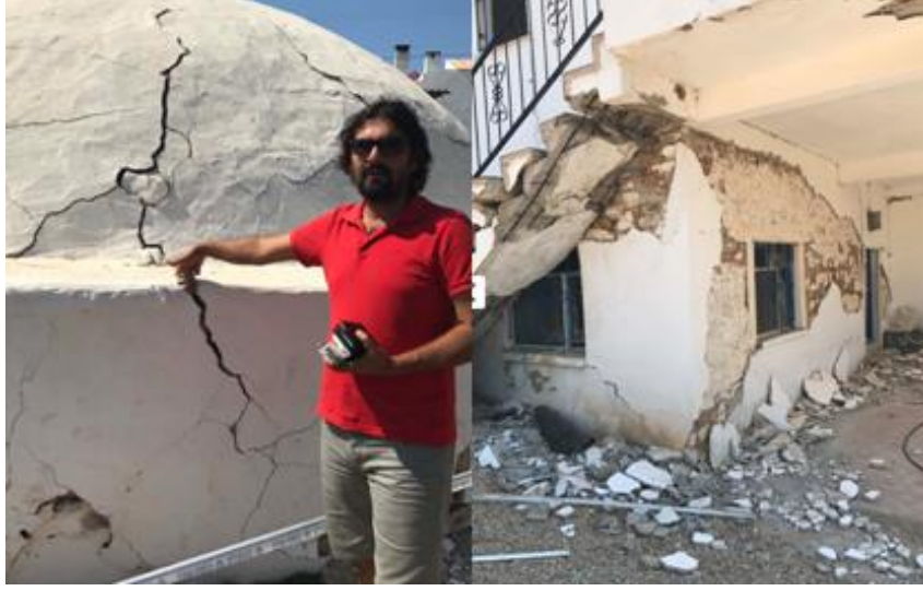
Şekil 6.24 2017 Bodrum Depremi'nin yapılarda meydana getirdiği hasarlar (İnt. Kyn. 13).
