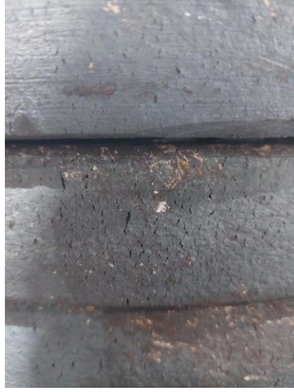
Şekil 1.1. Malzeme yüzeyinde oluşan çatlaklar
