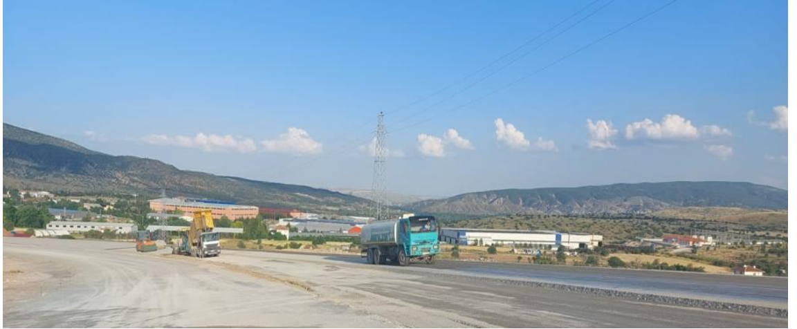
Şekil 1.6 Korgun-Kurşunlu arası yolda taban zemini
