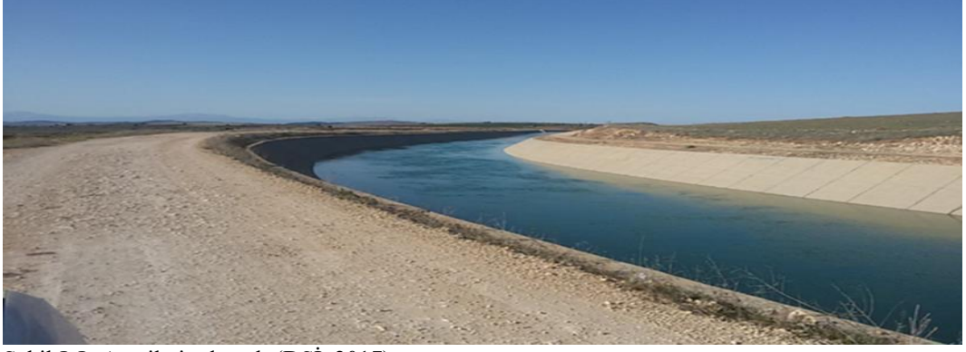
Şekil 3.3. Ana iletim kanalı (DSİ, 2017)
