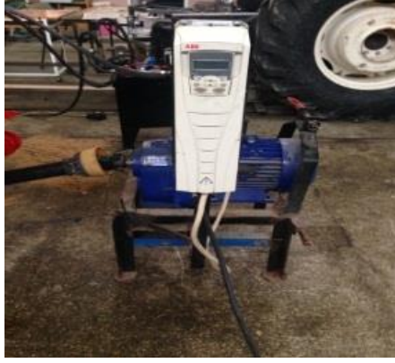
Şekil 3.12. Elektrik motoru frekans konvertörü.
