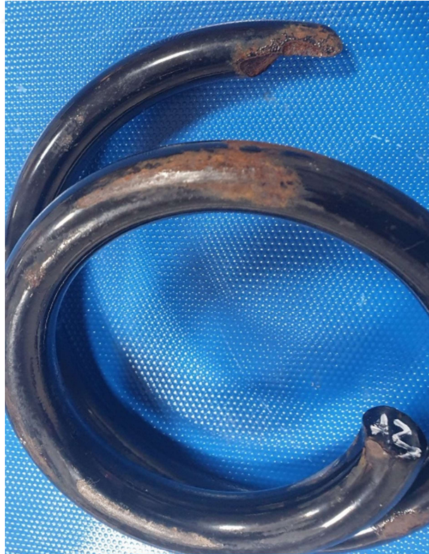
Şekil 4.15. Helisel yay yüzeyinde görülen korozyon
