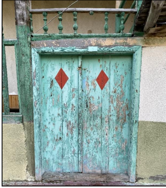
Şekil 74. Beklimçay Cami: giriş kapısındaki boya çatlakları ve dökülmeleri
