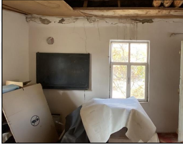
Şekil 75. Beklimçay Cami: oda-2 duvarlarında oluşan boya çatlakları ve renk değişimi
