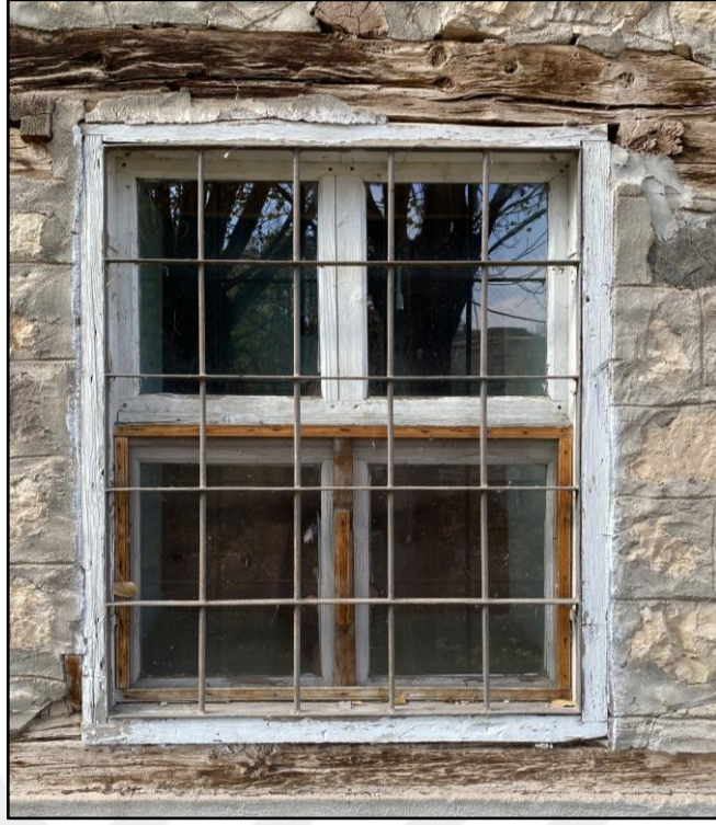
Şekil 6. Ahşap Elemanlardaki Bozulmalar: Aşınma
