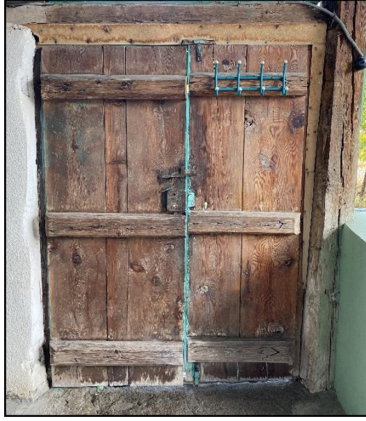
Şekil 67. Beklimçay Cami: bahçe giriş kapısında oluşan renk değişimi, çatlama ve parça kaybı
