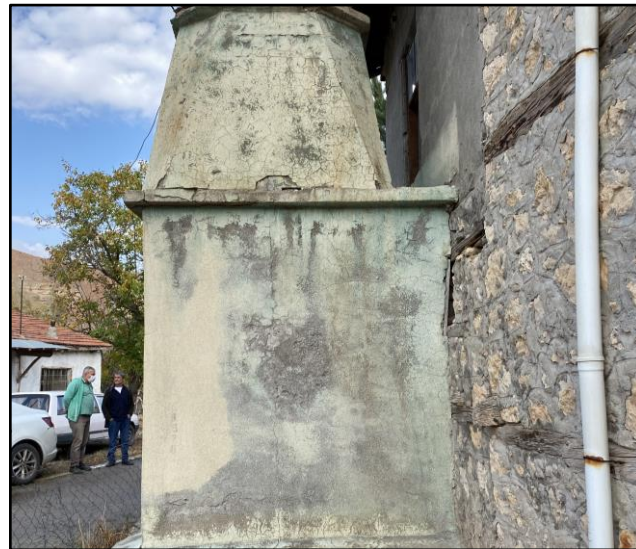
Şekil 21. Harç, Sıva ve Boya Bozulmaları: Renk Değişimi
