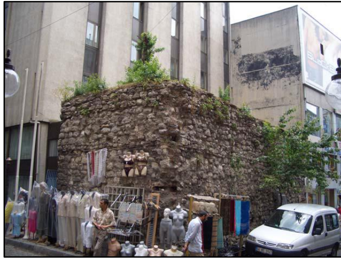
Şekil 24. İnsan Etkisiyle Oluşan Bozulmalar: Bakımsızlık (Vatan Kaptan 2010)
