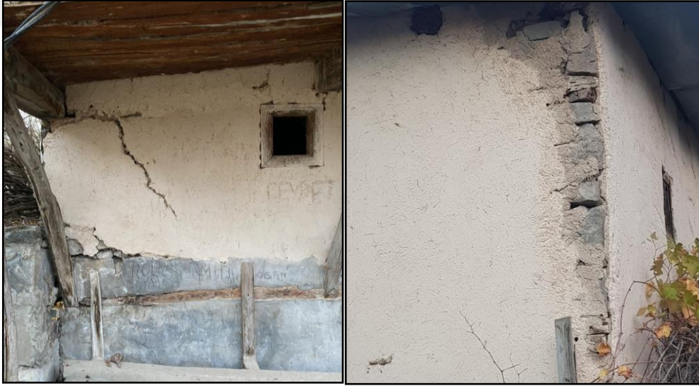
Şekil 90. Soğukpınar Cami: duvarlarda oluşan yapısal çatlaklar
