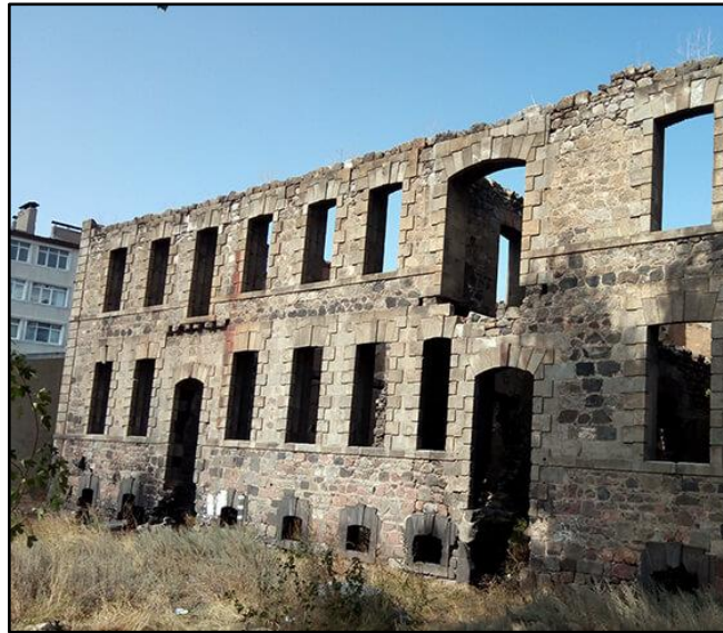
Şekil 26. Strüktürel Bozulmalar: Zemin Oturması (Anonim 2023e)
