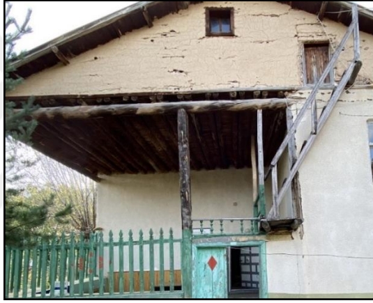
Şekil 68. Beklimçay Cami: ahşap direklerde oluşan kararmalar
