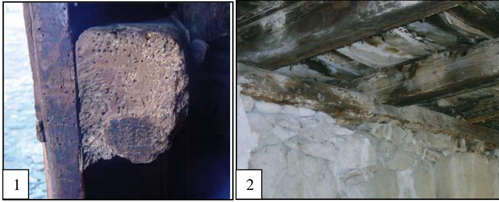
Şekil 9. Ahşap Elemanlardaki Bozulmalar: (1) Böcek ve Kurt Etkisi, (2) Küflenme (Perker ve Akıncıtürk 2006)
