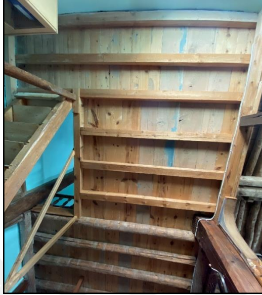
Şekil 77. Beklimçay Cami: mahfil döşemelerinde tespit edilen niteliksiz işçilik
