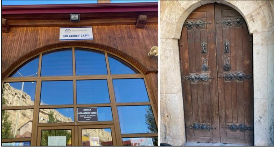
Şekil 118. Gülabibey Cami: ahşap yüzeylerde oluşan yüzey kirliliği, aşınma ve renk değişimi
