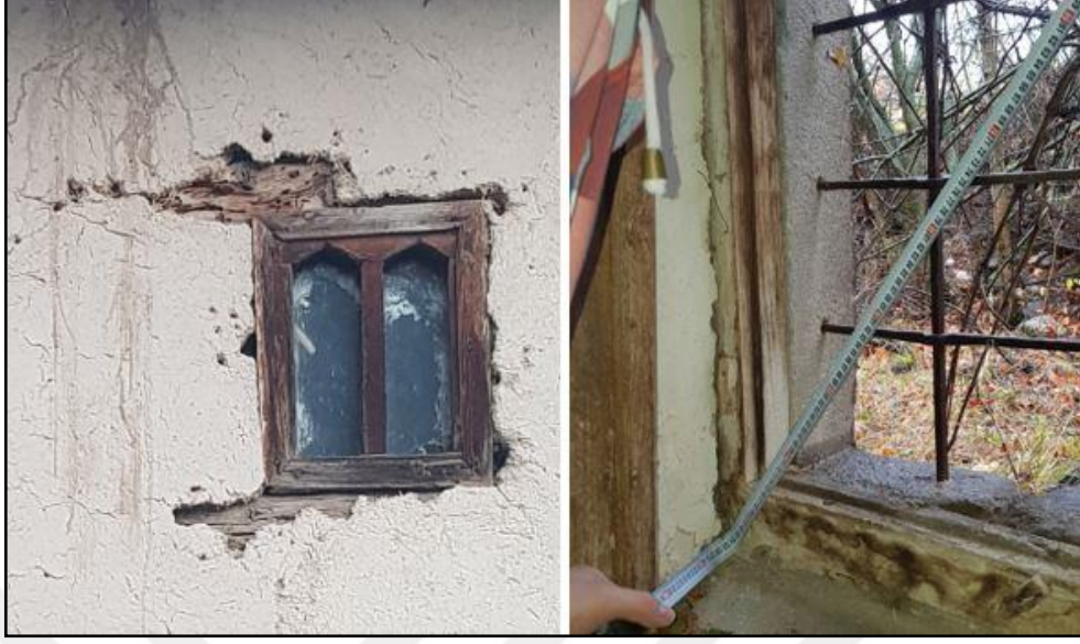
Şekil 82. Soğukpınar Cami: ahşap pencere kasalarında oluşan çürüme, renk değişimi ve küf oluşumu
