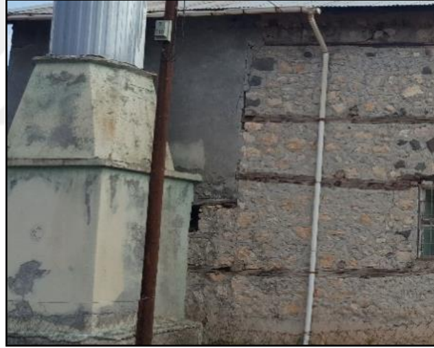
Şekil 88. Beklimçay Cami bilinçsiz müdahale örneği: pencere açıklıklarının kapatılması
