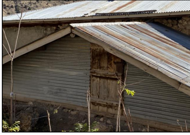
Şekil 103. Mektepönü Cami: çatı kapağında oluşan çatlama ve kararma
