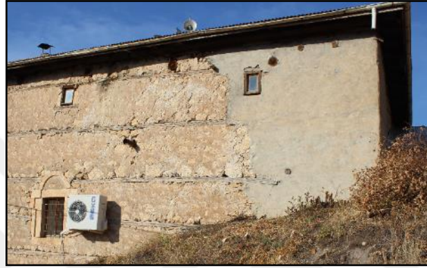
Şekil 108. Mektepönü Cami bilinçsiz müdahale örneği: taş yüzeylerin çimento katkılı harç ile sıvanması
