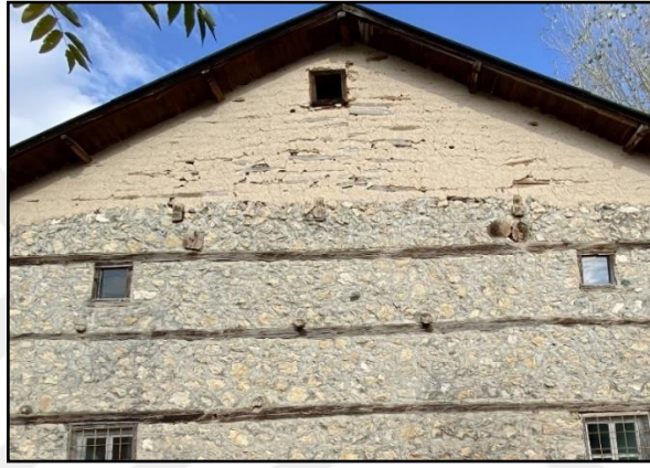
Şekil 72. Beklimçay Cami: beden duvarlarında oluşan sıva çatlakları ve dökülmeleri
