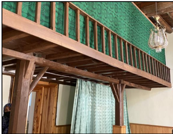
Şekil 106. Mektepönü Cami bilinçsiz müdahale örneği: mahfildeki ahşap elemanlara yapılan boya uygulaması
