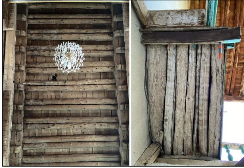
Şekil 65. Beklimçay Cami: ahşap tavan elemanlarında oluşan renk değişimi
