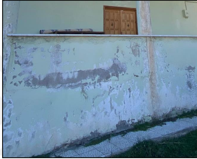
Şekil 20. Harç, Sıva ve Boya Bozulmaları: Çatlama ve Dökülme
