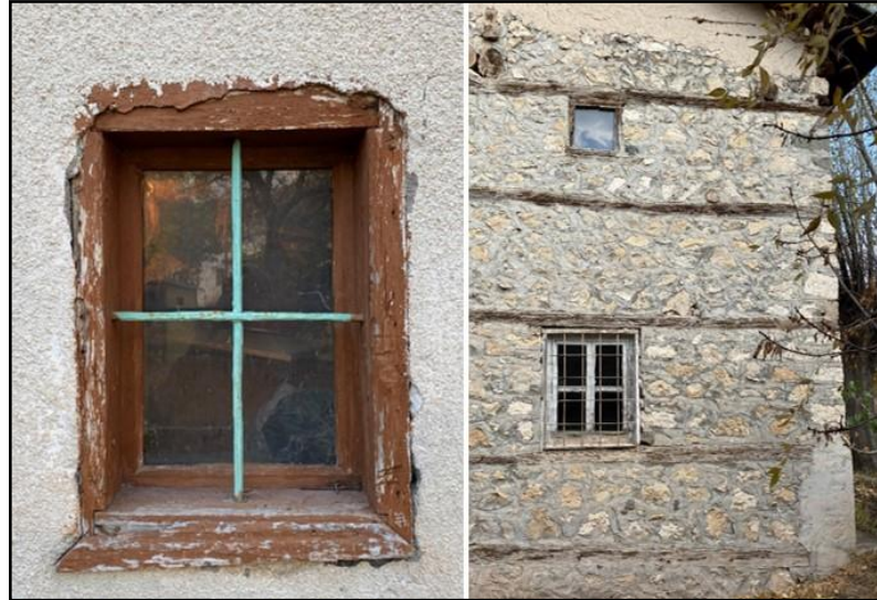
Şekil 64. Beklimçay Cami: ahşap pencere kasalarında ve ahşap hatıllarda oluşan yüzey kirliliği, aşınma ve çatlamlar
