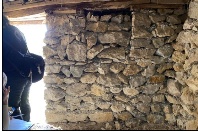
Şekil 58. Aşağıgedik Cami: odunluk duvarlarında oluşan yüzey kirliliği, aşınma ve derz boşalmaları
