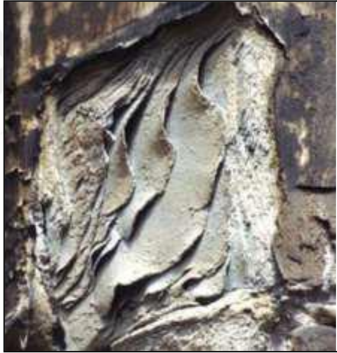
Şekil 15. Taş Elemanlardaki Bozulmalar: Yapraklanma (MEB 2013)
