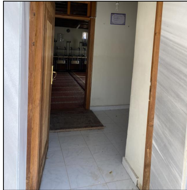
Şekil 109. Mektepönü Cami niteliksiz ek ve bilinçsiz müdahale örneği: medrese zeminine yapılan seramik kaplama uygulaması
