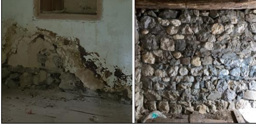
Şekil 85. Soğukpınar Cami: harim ve depo duvarlarında oluşan derz boşalmaları
