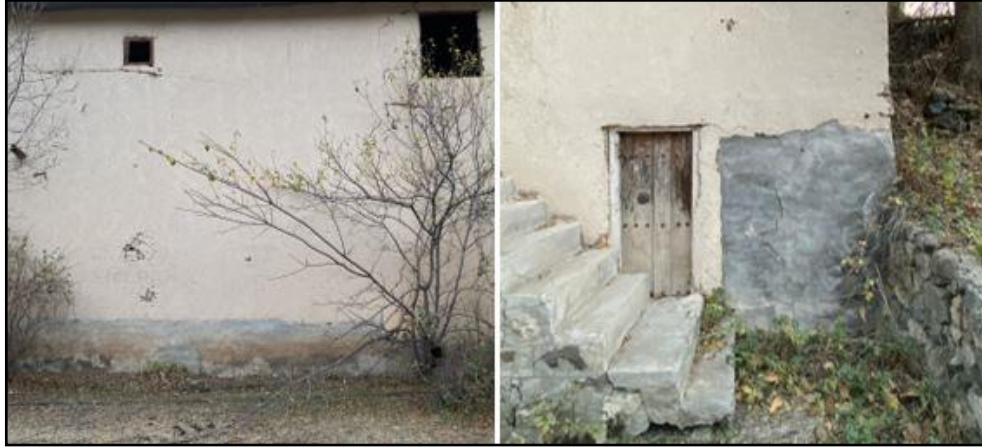
Şekil 88. Soğukpınar Cami niteliksiz müdahale örneği: beden duvarlarının bir bölümünün çimento katkılı harç ile sıvanması
