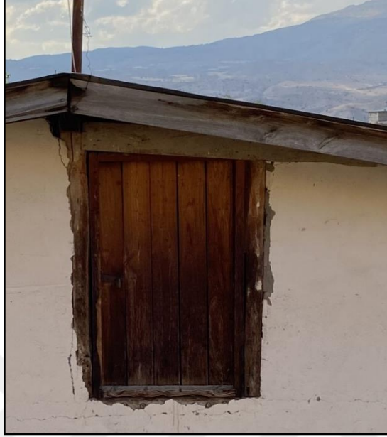
Şekil 56. Aşağıgedik Cami: çatı kapağında oluşan renk değişimi ve küf oluşumu
