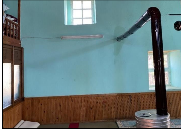
Şekil 91. Beklimçay Cami niteliksiz ek ve bilinçsiz müdahale örneği: iç duvarlara lambri uygulaması
