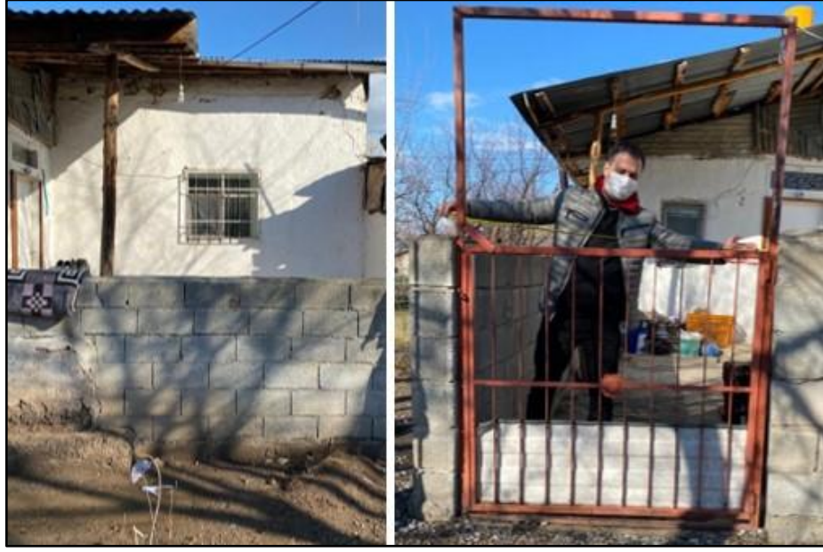
Şekil 79. Beklimçay Cami: lojman yapısına eklenen niteliksiz duvar ve demir kapı
