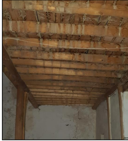
Şekil 89. Soğukpınar Cami: harim ahşap tavanlarında oluşan sehim
