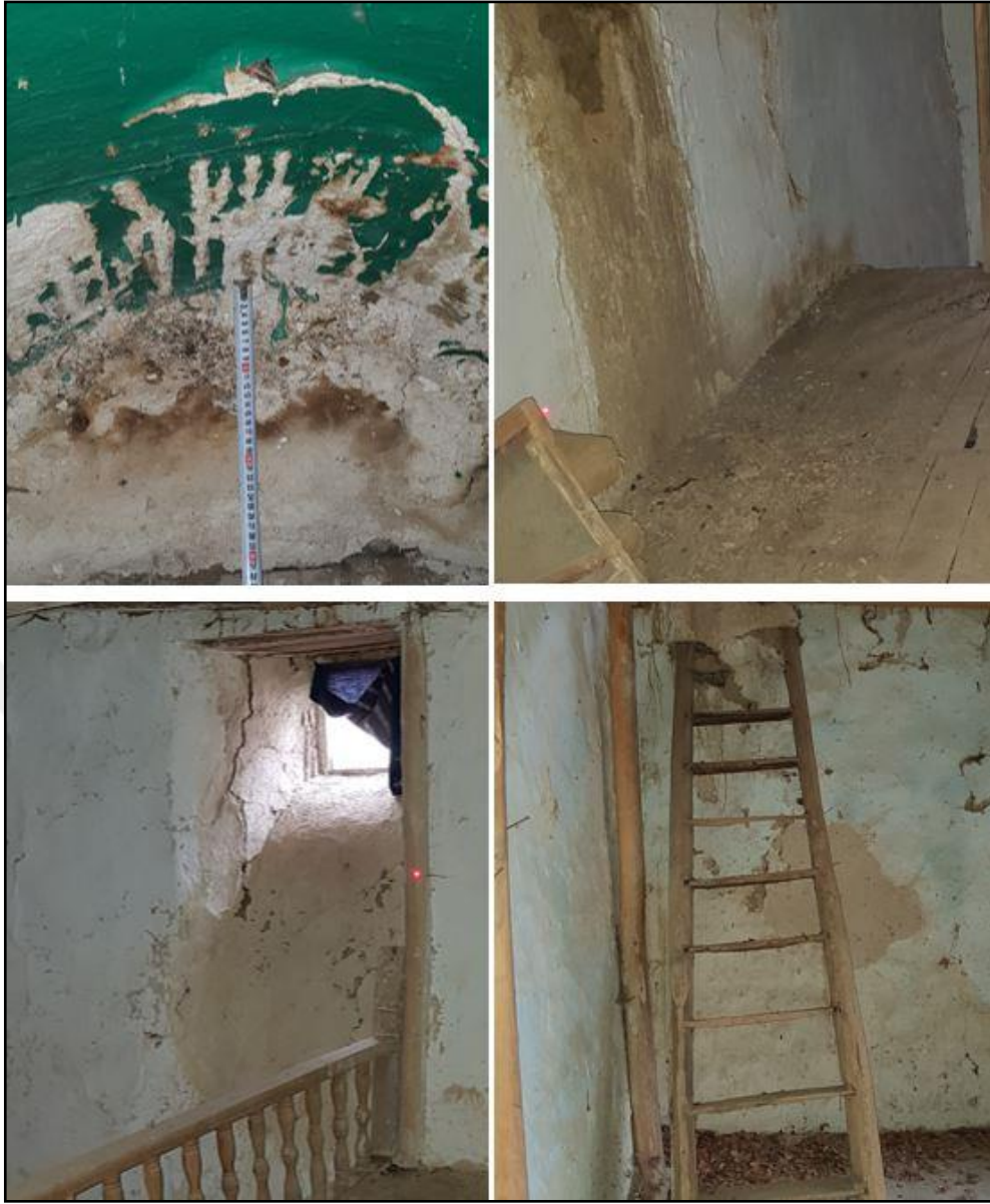
Şekil 86. Soğukpınar Cami: mihrap ve sıvalı cami duvarlarında oluşan renk değişimi, çatlama ve sıva dökülmeleri
