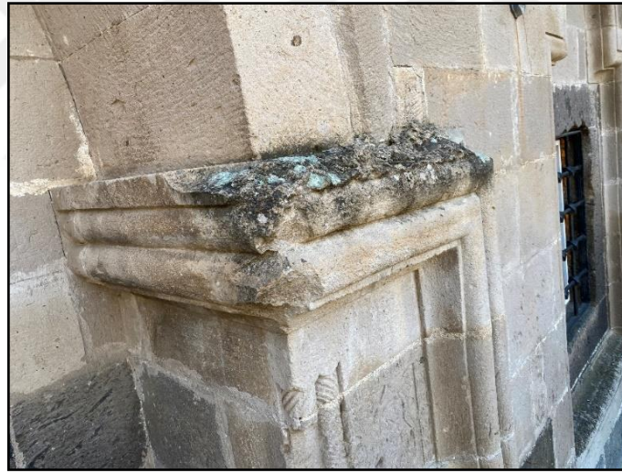
Şekil 19. Taş Elemanlardaki Bozulmalar: Mantar (Küf) Oluşumu
