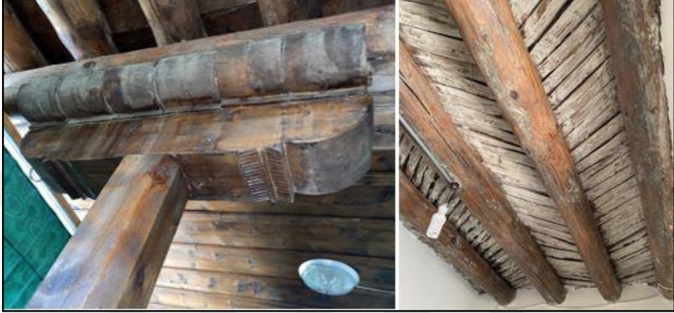
Şekil 101. Mektepönü Cami: ahşap sütun başlıklarında, kiriş ve kaplama tahtalarında oluşan çatlama ve renk değişimi
