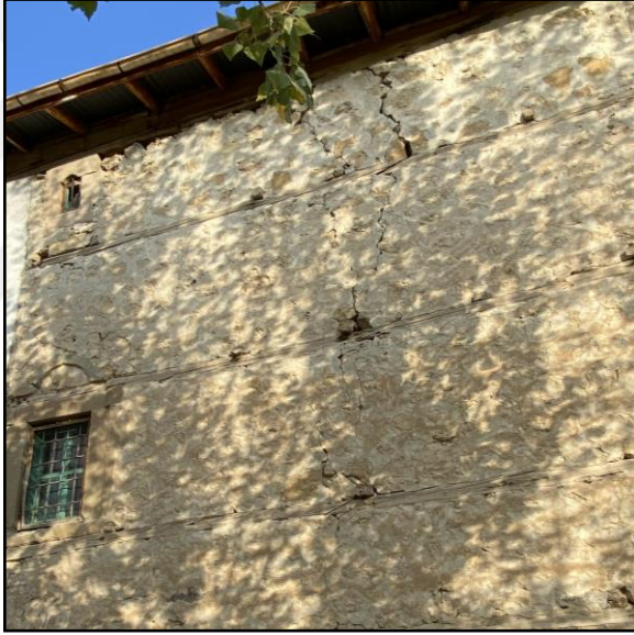
Şekil 70. Aşağıgedik Cami: harim duvarlarında oluşan yapısal çatlaklar
