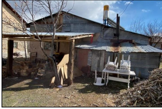
Şekil 95. Beklimçay Cami niteliksiz ek ve bilinçsiz müdahale örneği: lojman yapısına eklenen sac sundurmalar
