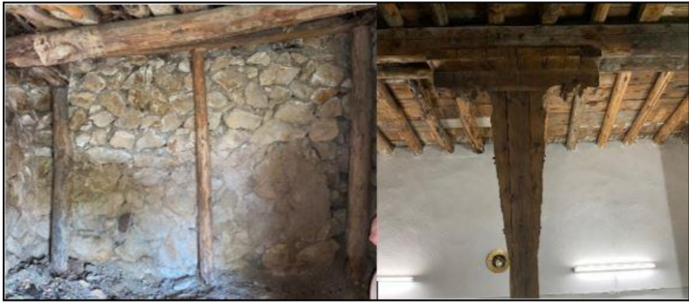
Şekil 55. Aşağıgedik Cami: ahşap kirişlerde ve direklerde oluşan renk değişimi
