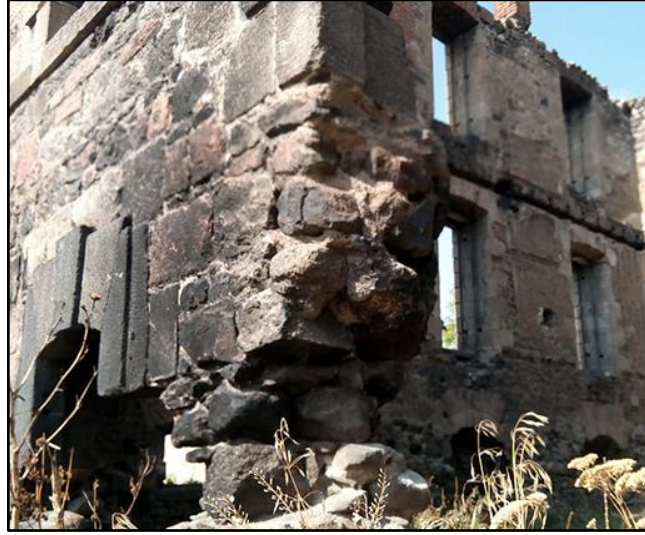
Şekil 28. Strüktürel Bozulmalar: Yıkılma (Anonim 2023e)
