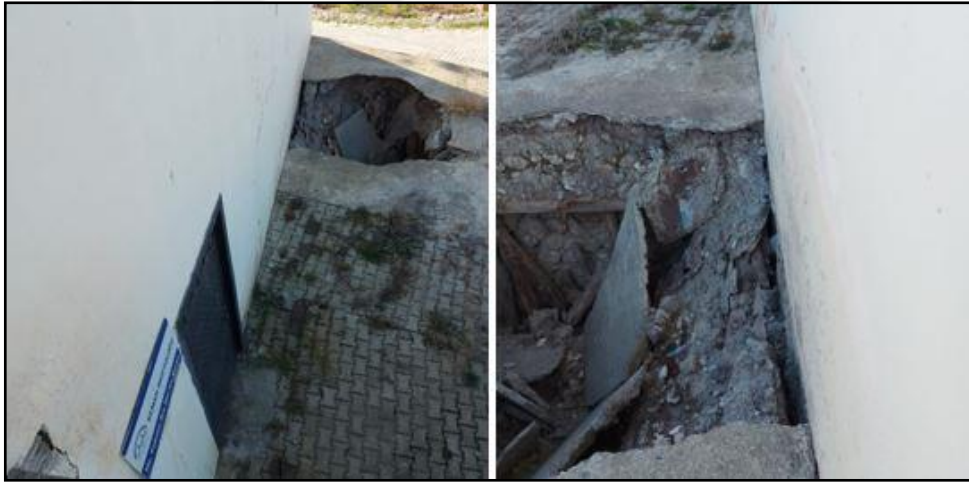
Şekil 68. Aşağıgedik Cami: odunluk tavanında oluşan yıkılma/çökme
