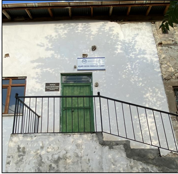
Şekil 64. Aşağıgedik Cami niteliksiz ek ve bilinçsiz müdahale örneği: giriş cephesinin değiştirilmesi
