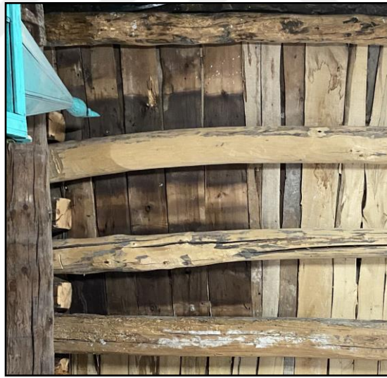
Şekil 57. Aşağıgedik Cami: harim ahşap tavanında oluşan renk değişimi ve küf oluşumu
