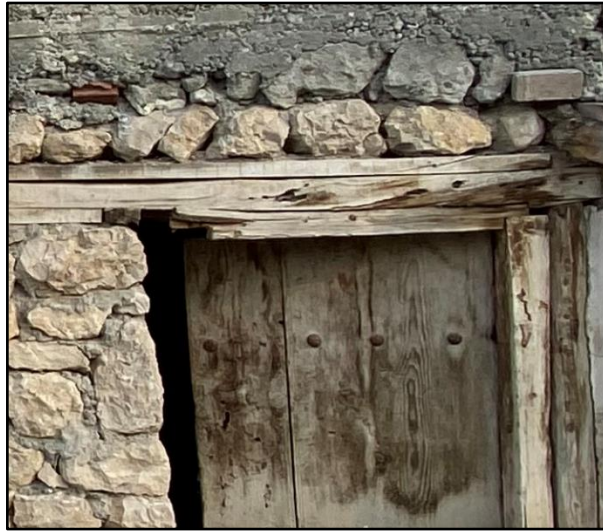
Şekil 7. Ahşap Elemanlardaki Bozulmalar: Çatlak, Kırık ve Parça Kopması
