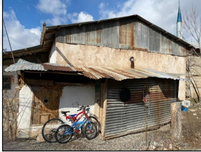
Şekil 80. Beklimçay Cami: lojman yapısına eklenen niteliksiz ek ve bilinçsiz müdahale örneği sac sundurma
