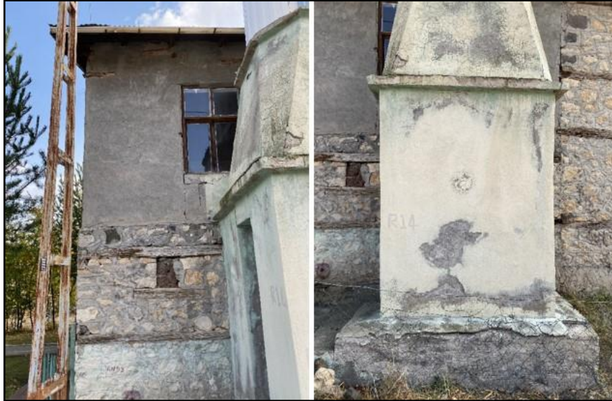
Şekil 73. Beklimçay Cami: boyalı yüzeylerde oluşan çatlaklar ve dökülmeler
