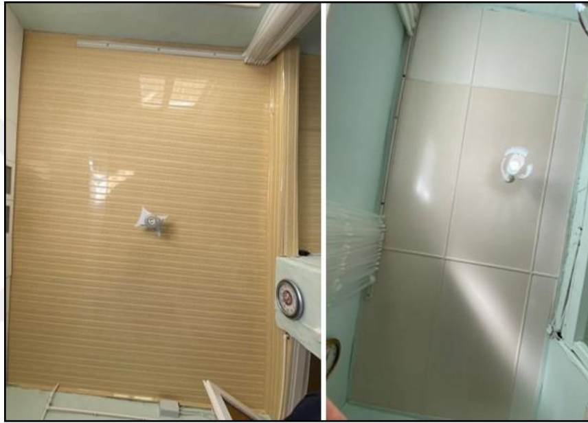
Şekil 96. Beklimçay Cami niteliksiz ek ve bilinçsiz müdahale örneği: lojman tavanlarına lambri uygulaması
