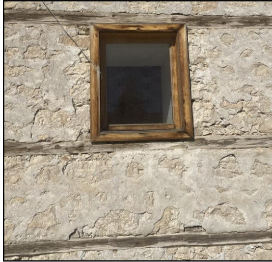
Şekil 102. Mektepönü Cami: ahşap hatıllarda ve ahşap pencere kasalarında oluşan yüzey kirliliği, çatlama, parça kayıpları ve renk değişimi
