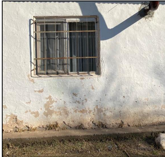
Şekil 71. Beklimçay Cami: derz boşluklarında gelişen bitkilenmeler
