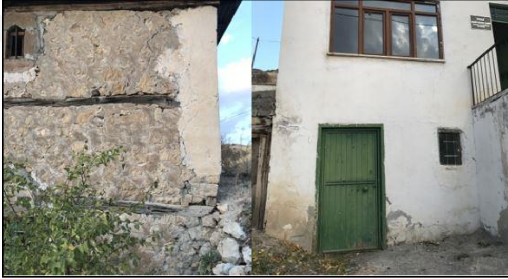
Şekil 62. Aşağıgedik Cami: duvarlarda oluşan sıva çatlakları, boya ve harç dökülmeleri
