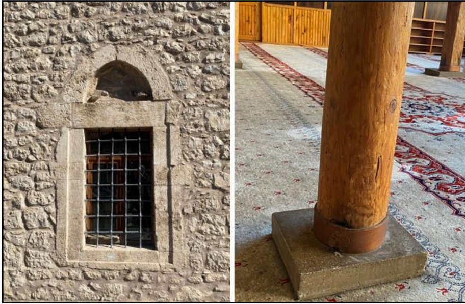
Şekil 119. Gülabibey Cami: Taş yüzeylerde oluşan yüzey kirliliği, aşınma ve oyuklanmalar
