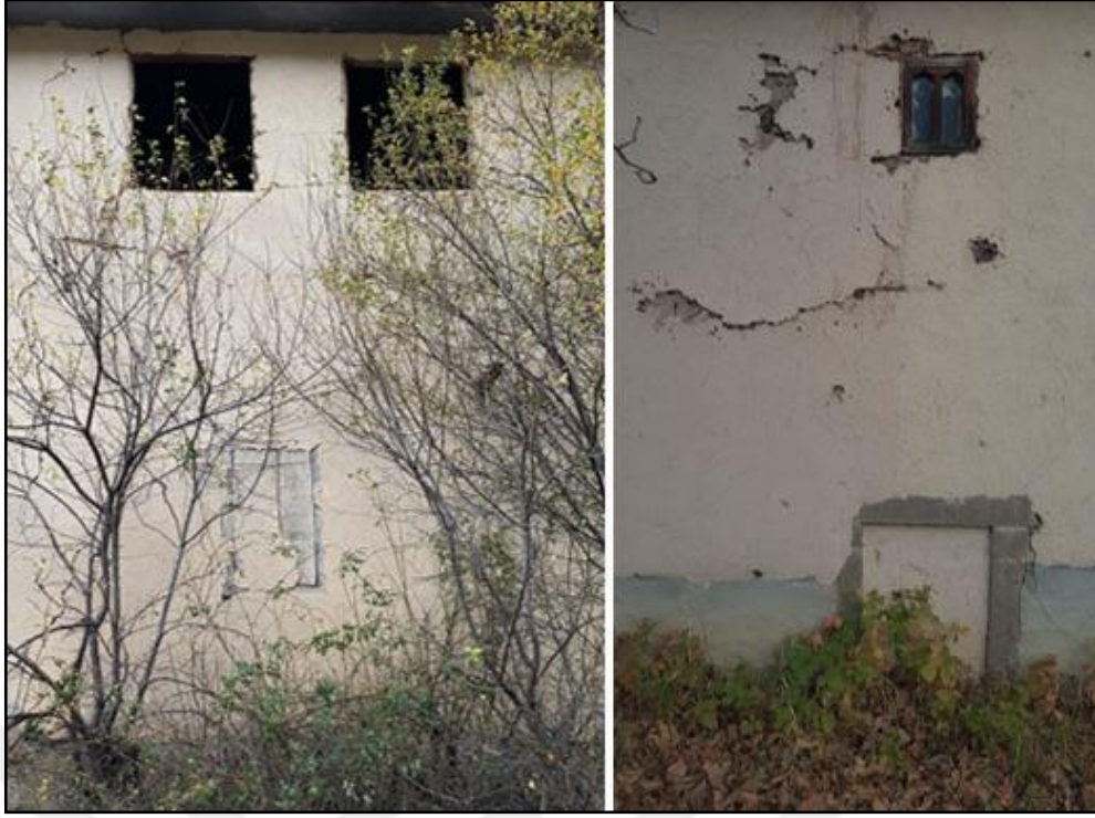
Şekil 87. Soğukpınar Cami niteliksiz müdahale örneği: son cemaat mahali ve harimdeki pencere boşluklarının kapatılması
