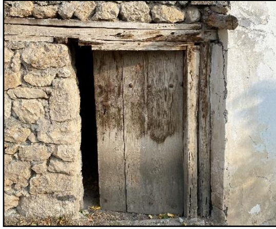
Şekil 54. Aşağıgedik Cami: odunluk kapısında oluşan yüzey kirliliği, çatlama, parça kaybı ve renk değişimi
