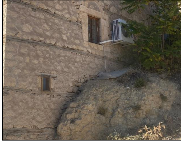
Şekil 105. Mektepönü Cami: derz boşluklarında gelişen bitkilenme
