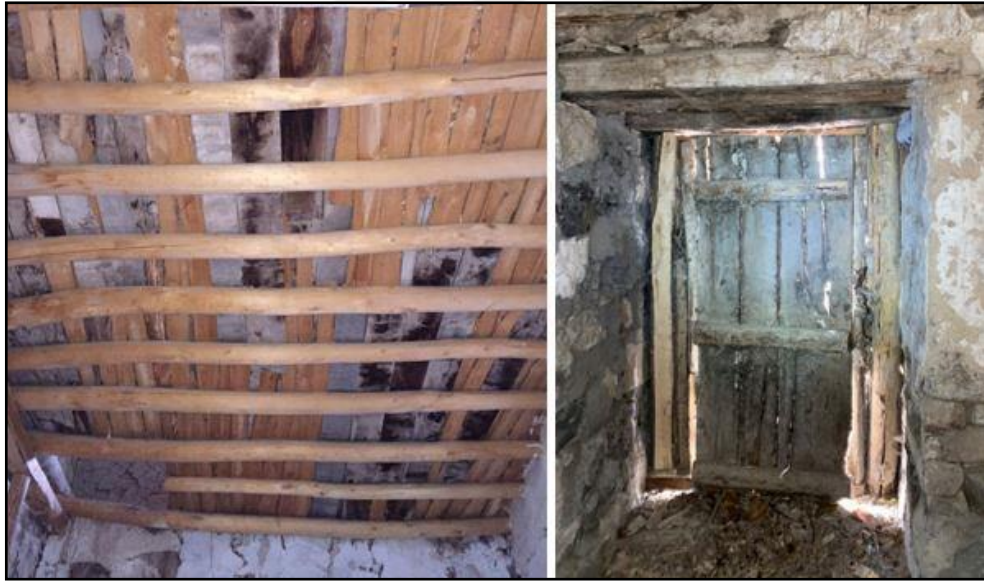
Şekil 83. Soğukpınar Cami: son cemaat mahalindeki ahşap tavanda ve depo kapısında oluşan renk değişimi ve küf oluşumu
