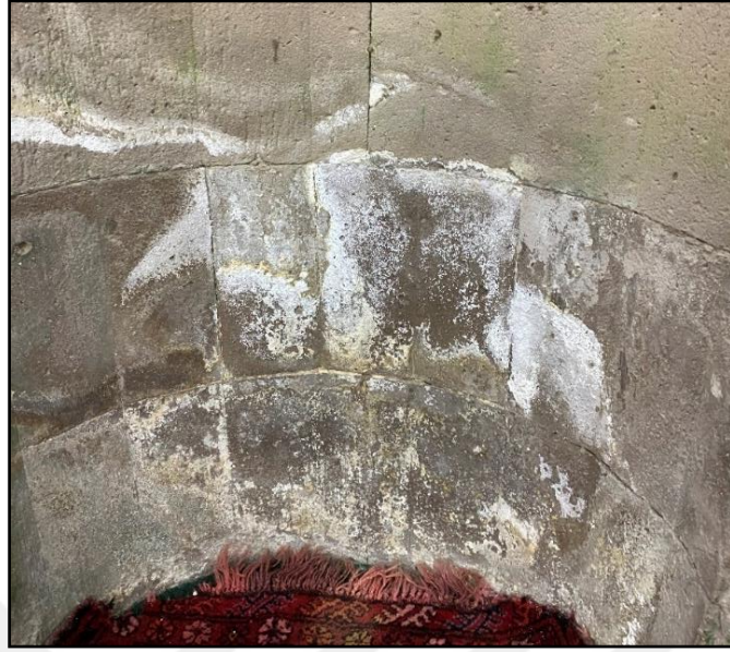
Şekil 16. Taş Elemanlardaki Bozulmalar: Tuzlanma (Çiçeklenme)
