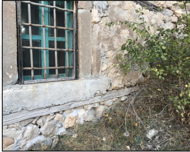
Şekil 59. Aşağıgedik Cami: taş duvarlarda oluşan bitkilenme
