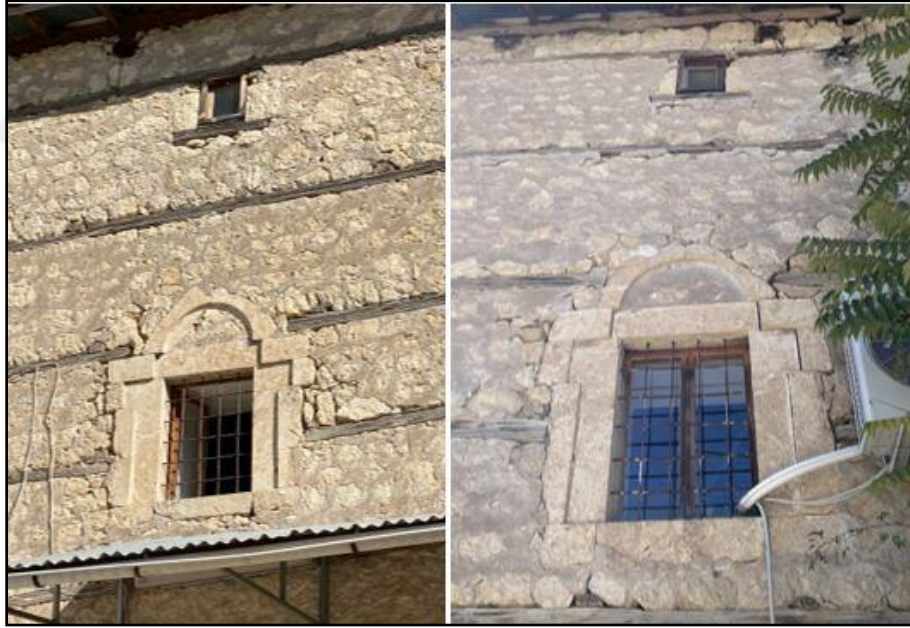
Şekil 104. Mektepönü Cami: taş duvarlarda oluşan yüzey kirliliği, aşınma, oyuklanma ve renk değişimi
