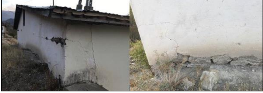
Şekil 61. Aşağıgedik Cami: duvarlarda oluşan sıva ve boya dökülmeleri
