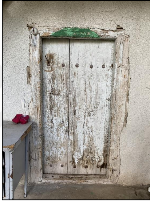
Şekil 81. Beklimçay Cami bakımsızlık örneği: depo kapısı
