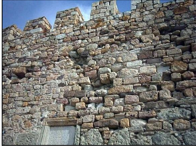
Şekil 22. Harç, Sıva ve Boya Bozulmaları: Derz Boşalmaları (Hasbay 2017)
