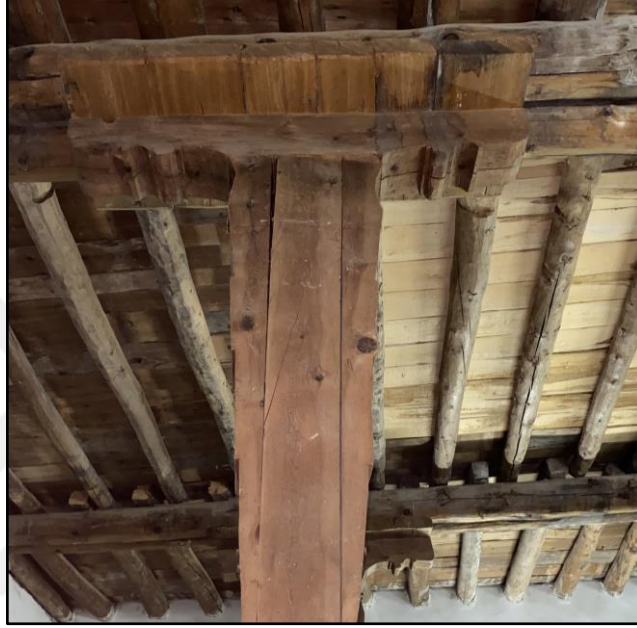
Şekil 5. Ahşap Elemanlardaki Bozulmalar: Yüzey Kirliliği
