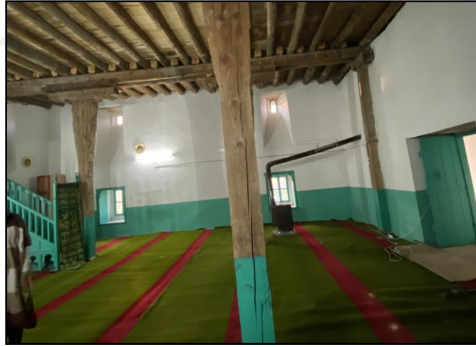
Şekil 66. Aşağıgedik Cami bilinçsiz müdahale örneği: harim duvarlarındaki niteliksiz boya uygulaması
