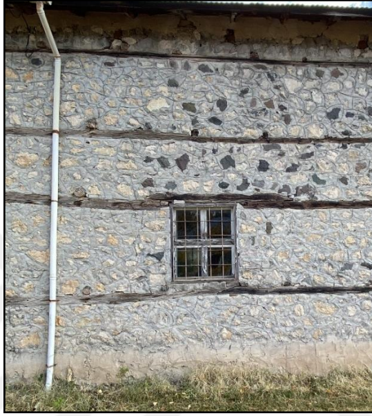
Şekil 70. Beklimçay Cami: taş duvarlarda oluşan yüzey kirliliği, aşınma ve oyuklanma
