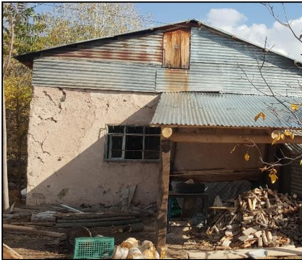
Şekil 2076. Beklimçay Cami: lojman beden duvarlarında oluşan sıva çatlakları ve dökülmeleri
