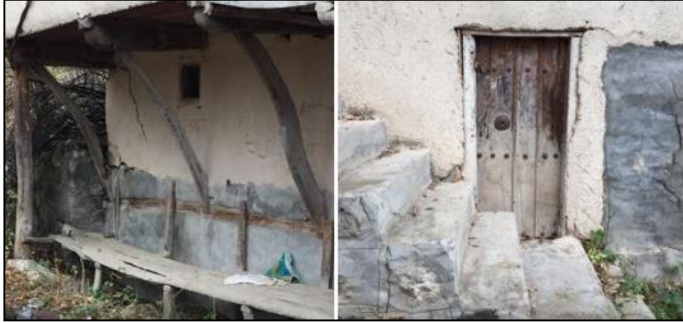
Şekil 81. Soğukpınar Cami: kuzey cephesindeki konsollarda, dikmelerde, kirişlerde ve ahşap odunluk kapısında oluşan yüzey kirliliği, çatlama, çürüme ve renk değişimi
