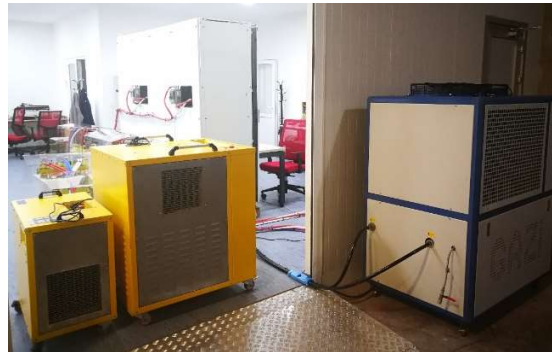
Şekil 6.35: Soğutma sistemi ve yük bankaları.
