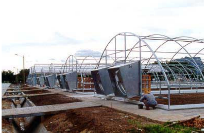
Şekil 2.11. Seranın ilk kurulumu sırasında fanların yerleştirilmesi
