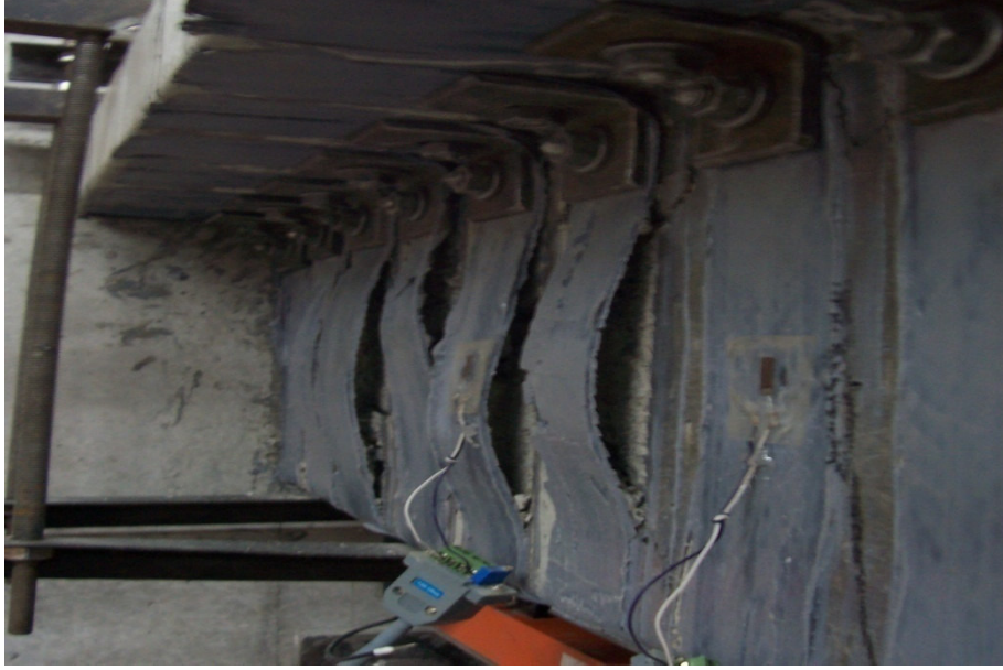
Şekil 3.68 CFRP şeritler orta bölgelerinden beton yüzeyinden ayrılmış
