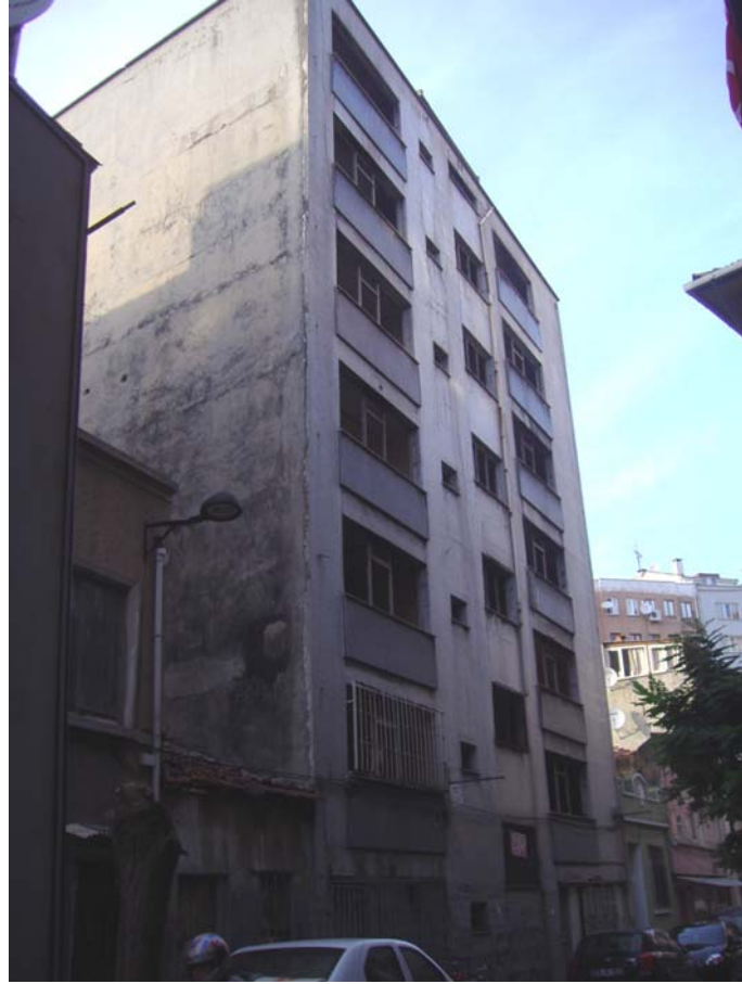
Şekil 4.10 Depremde hasar görmüş ve belediye tarafından mühürlenmiş bir yapı (C.Elgin)
