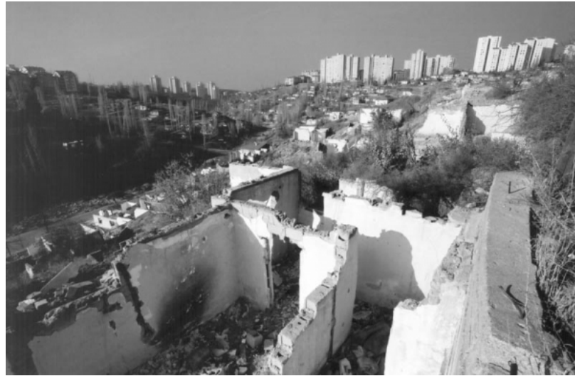
Şekil 3.26 Dikmen Vadisi’ndeki gecekonduların yıkımı (www.mimarlarodasiankara.org)
