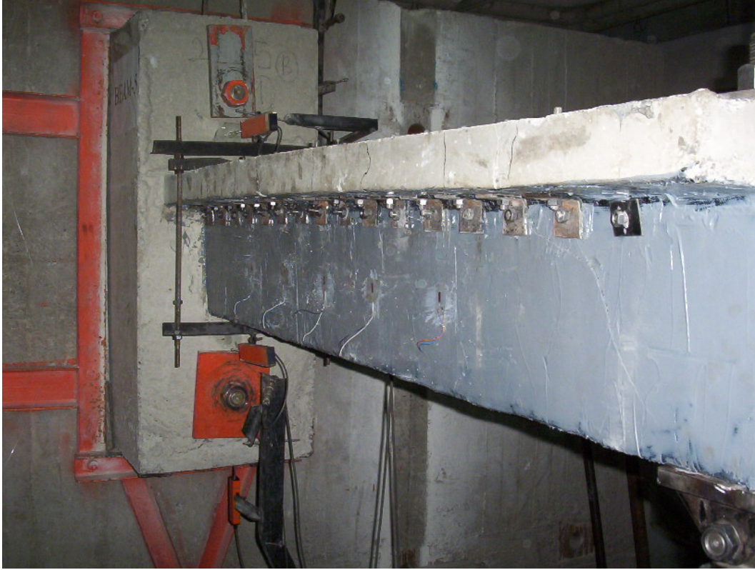
Resim 3.9. Göçme sonrası Kiriş-5 deney elemanı [21]
