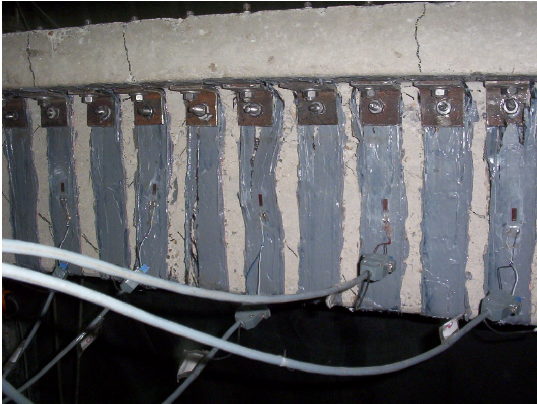
Resim 3.4. Ankraj bölgesinde CFRP şeritlerde oluşan kopmalar [21]
