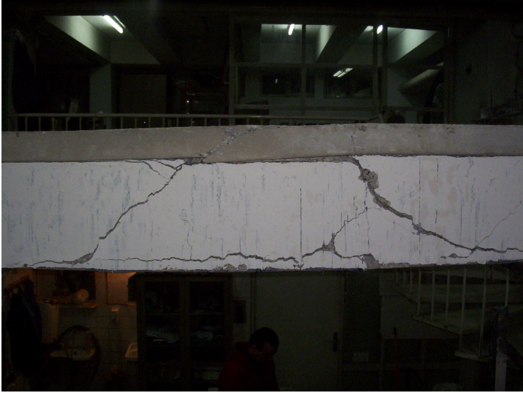
Resim 3.2. Deney elemanında oluşan iki ana kesme çatlağı [21]
