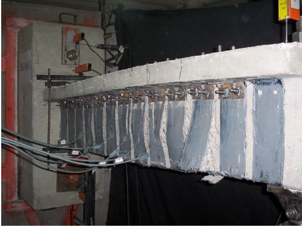
Resim 3.6. Kesme çatlağından dolayı kopan CFRP şerit [21]
