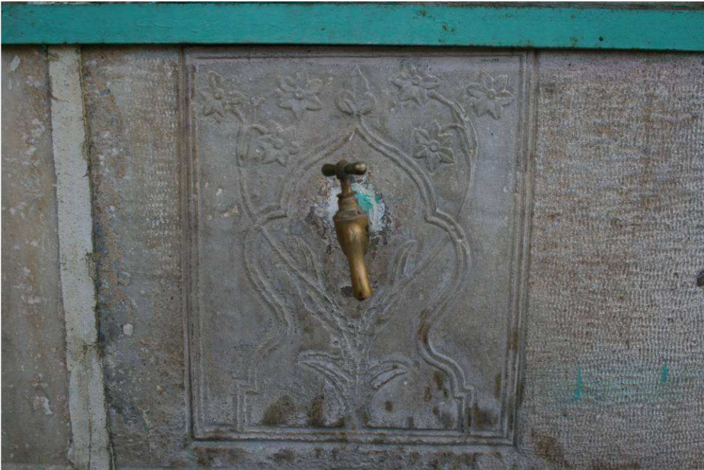
Resim 188: Tire Yalınayak Camii Şadırvanı Su Haznesi Panosu
