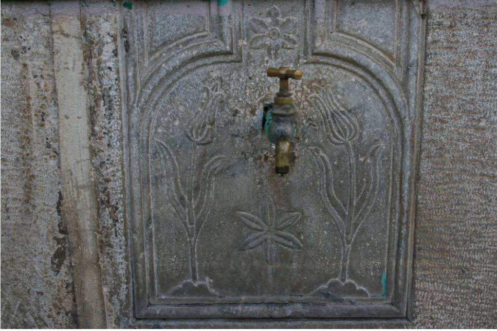
Resim 189: Tire Yalınayak Camii Şadırvanı Su Haznesi Panosu
