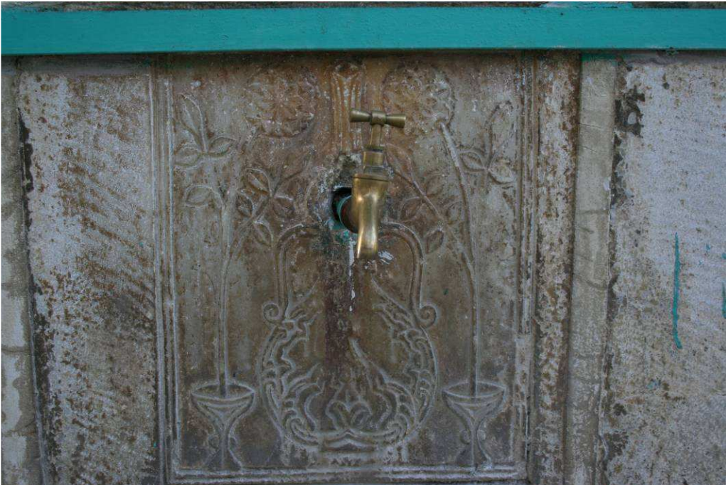
Resim 186: Tire Yalınayak Camii Şadırvanı Su Haznesi Panosu
