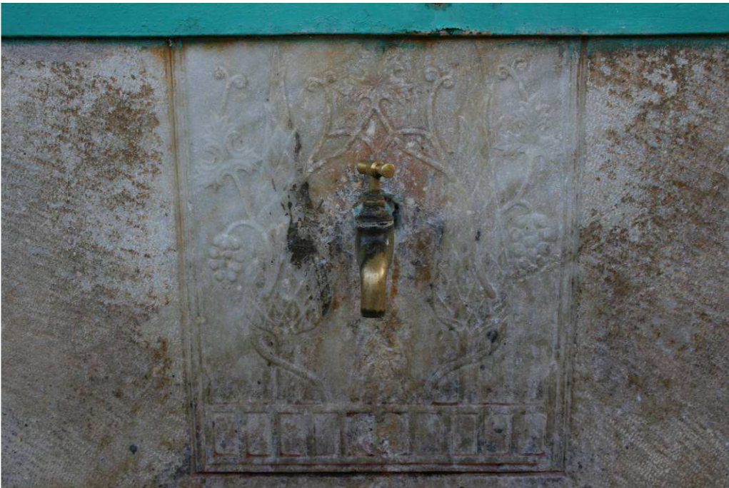
Resim 190: Tire Yalınayak Camii Şadırvanı Su Haznesi Panosu
