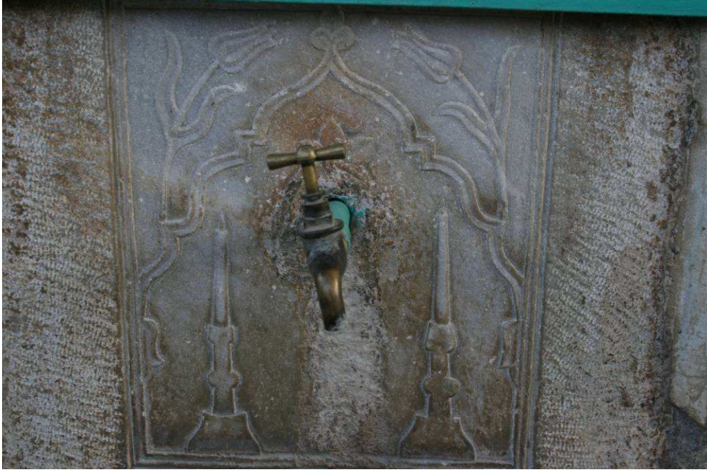
Resim 191: Tire Yalınayak Camii Şadırvanı Su Haznesi Panosu
