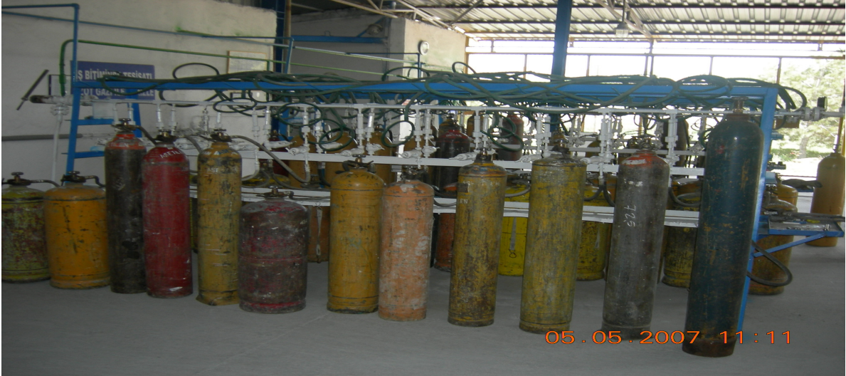
Şekil 3.9. Asetilen Dolum Ünitesi
