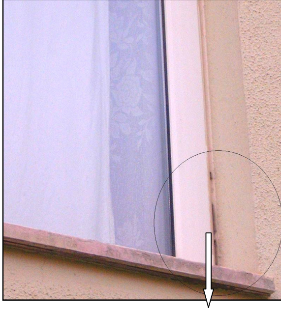
Resim 7.11. Duvar- pencere birleşimindeki yalıtım malzemesi ve işçilikten kaynaklanan yalıtım sorunu
