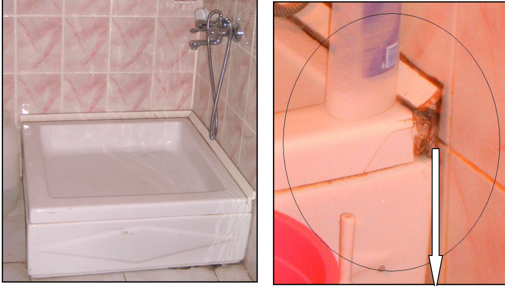
Resim 7.8. Banyodaki duş teknesinin malzeme ve yanlış işçilikten kaynaklanan deformasyon problemi
