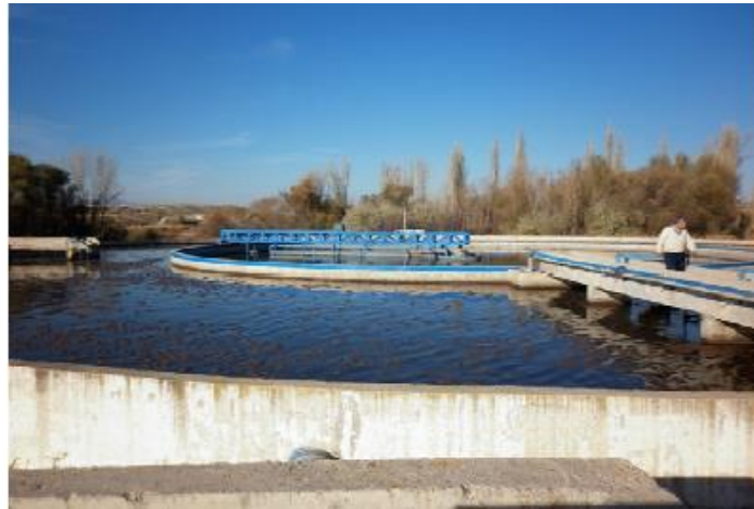
Görsel 3. 14. Ürgüp Katı Atık Arıtma Tesisi (http-88)
