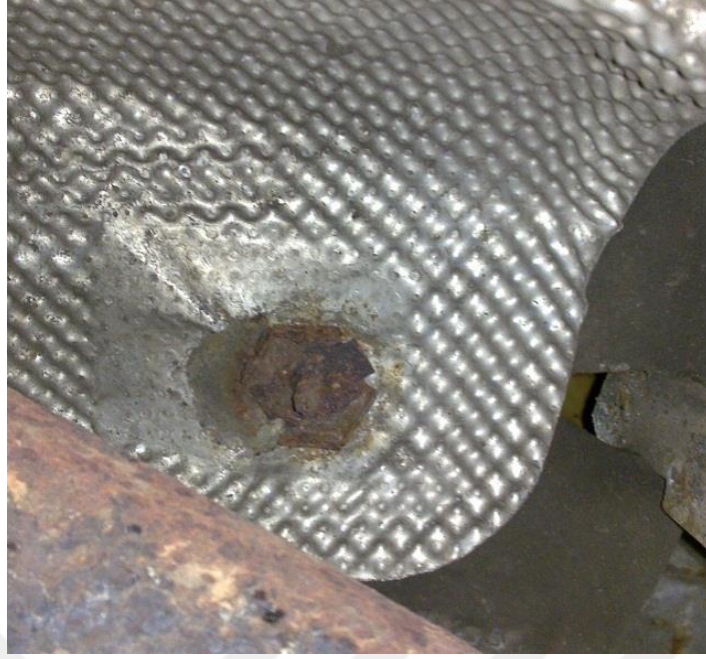
Şekil 4.9. Isı kalkanı montaj bileşenlerinde oluşan korozyon (Anonim,2018)
