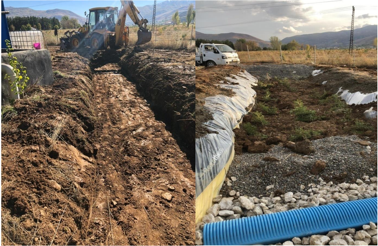
Şekil 2.1. Muş Şeker Fabrikası Yapay Sulakalan Sisteminin Yüzey Alanına ait bir görünüm
