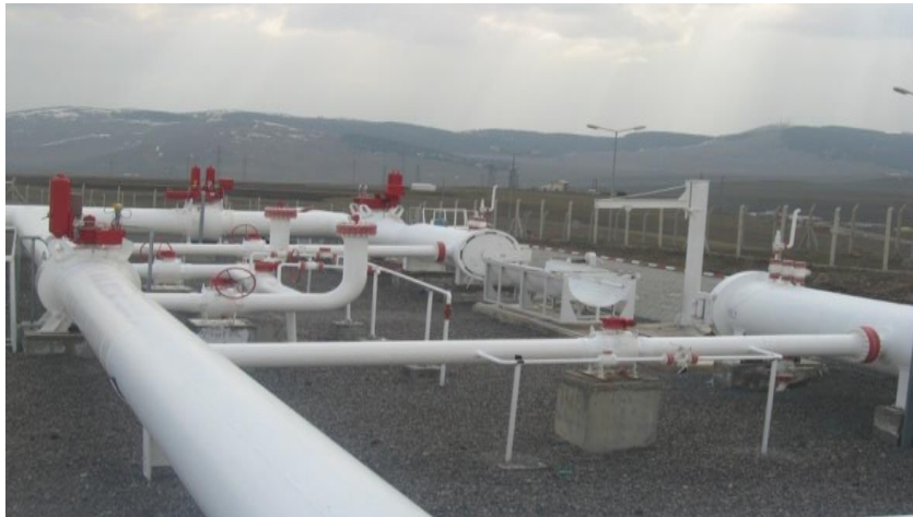
Şekil 3.3. İstasyon giriş/çıkış, pig alma/atma ve bypass sistemleri
