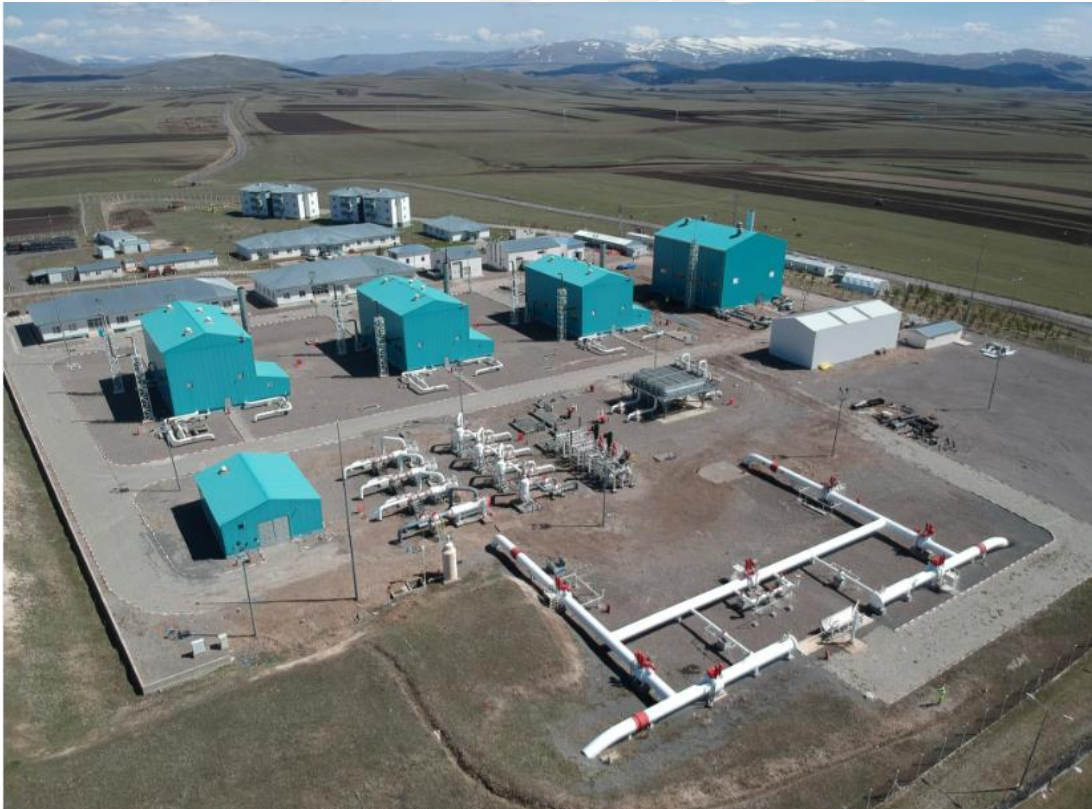
Şekil 3.2. Endüstriyel bir doğal gaz kompresör istasyonu
