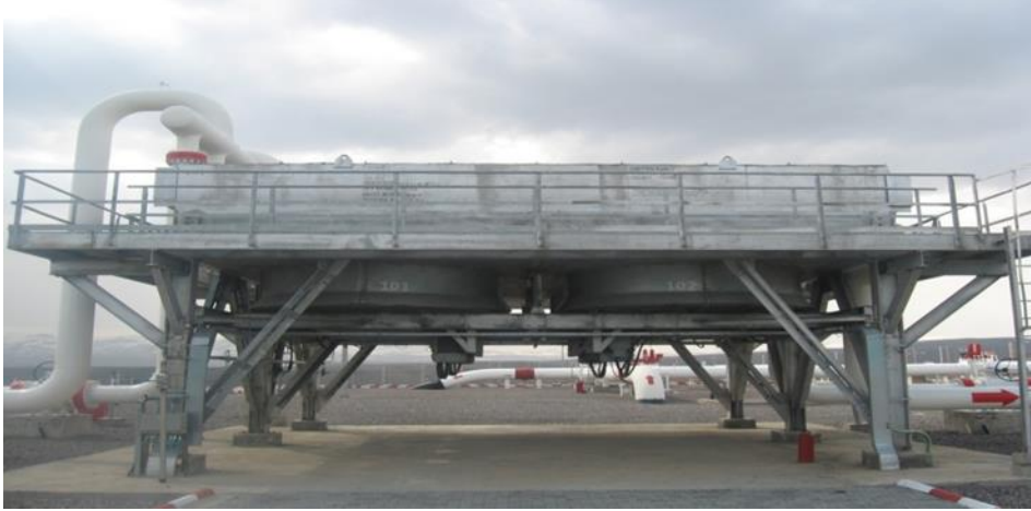
Şekil 3.13. Gaz soğutma sistemi
