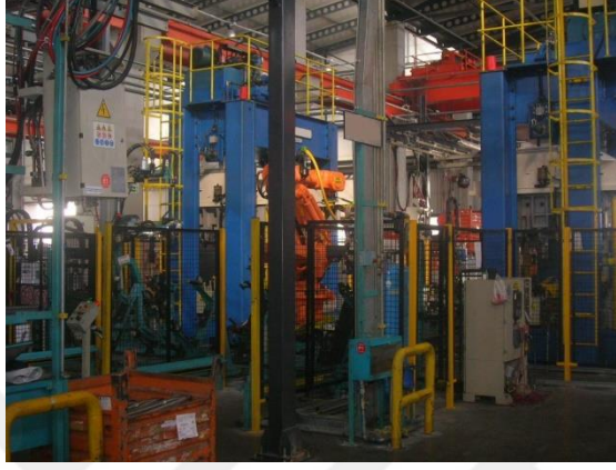
Şekil 2.3: Clinch hattı görünüşü
