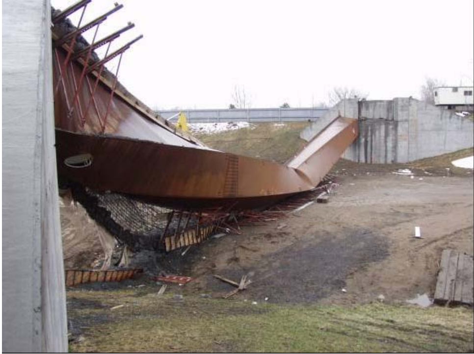
Şekil 3.7. Kendi ağırlığı altında eğilmeli yanal burkulmaya uğramış bir köprü.
