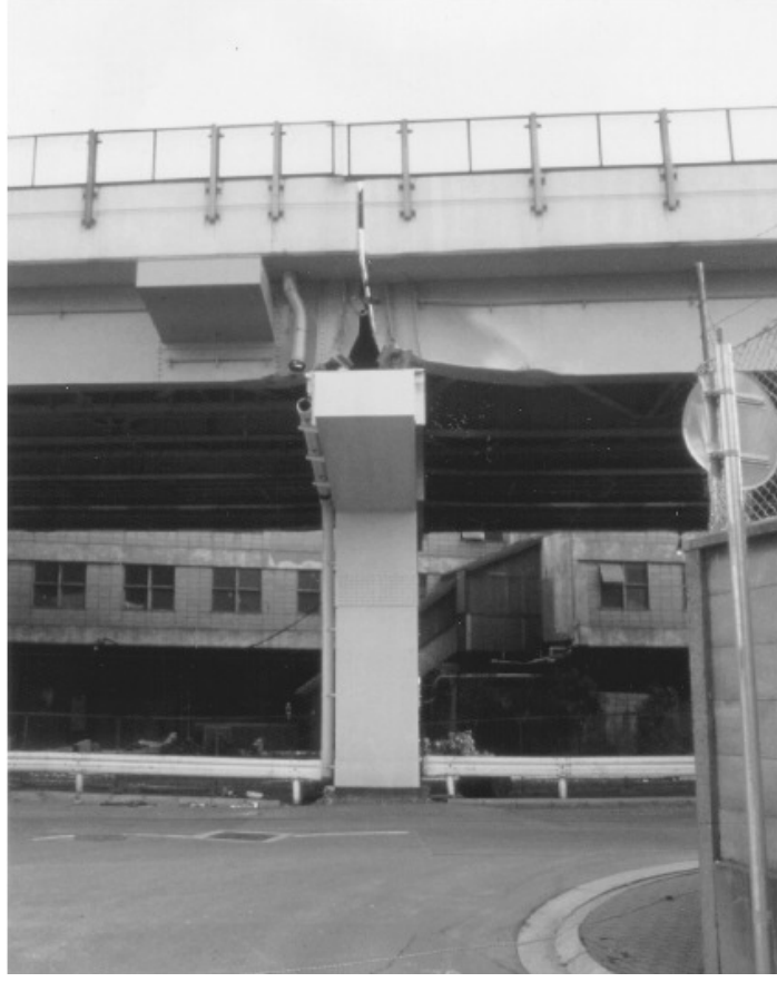
Şekil 2.4. 1995 Hyogo-Ken Nanbu depreminde hasar alan Hanshin otoban köprüsü [5].
