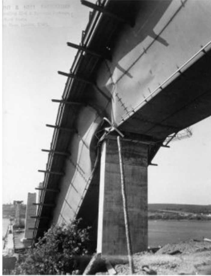
Şekil 3.8. Yetersiz berkitme tasarımı sonucu yıkılmış bir çelik köprü.
