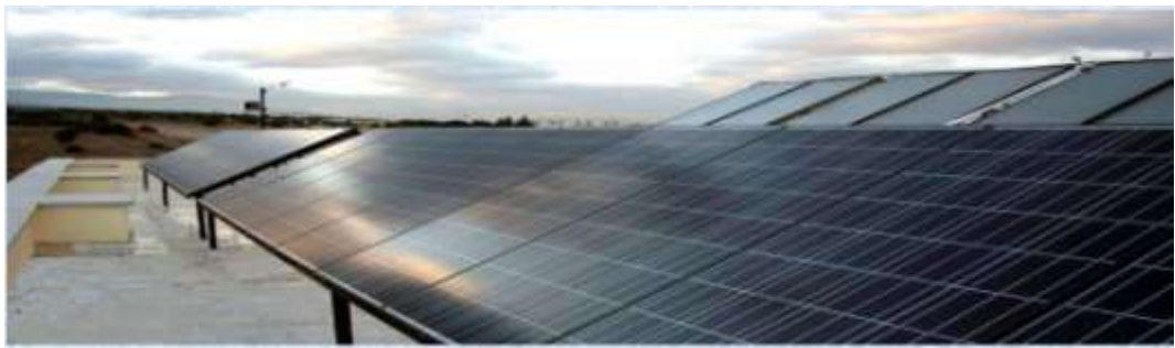
Şekil III.8 Fotovoltaiik Pillerden Elektrik Üretimi[59].
