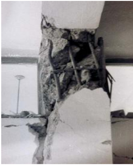
Şekil 3.11. Kısa Kolon Kırılması- 22 Mayıs 1971 Bingöl Depremi (Bayülke,2003)
