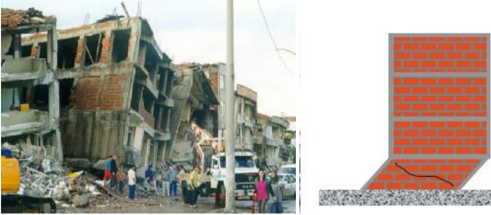
Şekil 3.12. Yumuşak Kat Oluşumu- Kocaeli depremi, 2000 (Shing ve ark.,2008)
