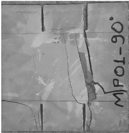
Resim 7.31. MP01-90 numunesinde çatlak yörüngesi
