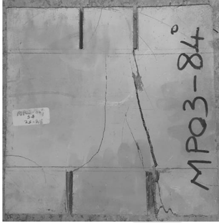
Resim 7.26. MP03-84 numunesinde çatlak yörüngesi
