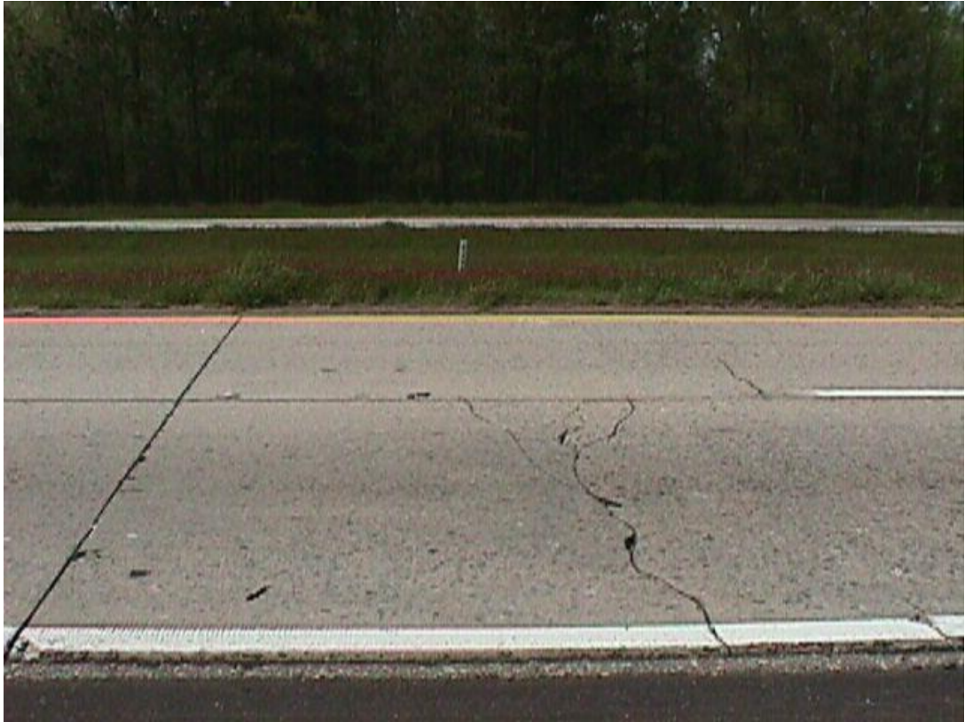
Şekil 3.24 : Beton yolda oluşan gelişigüzel enine çatlaklar.
