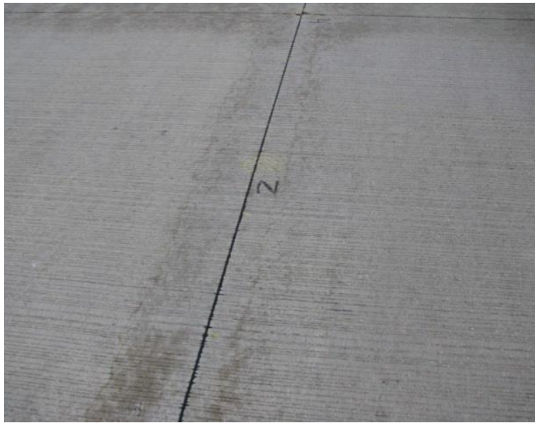
Şekil 3.27 : Buz çözücü etkisiyle derz çevresinde oluşan gölgelenme.
