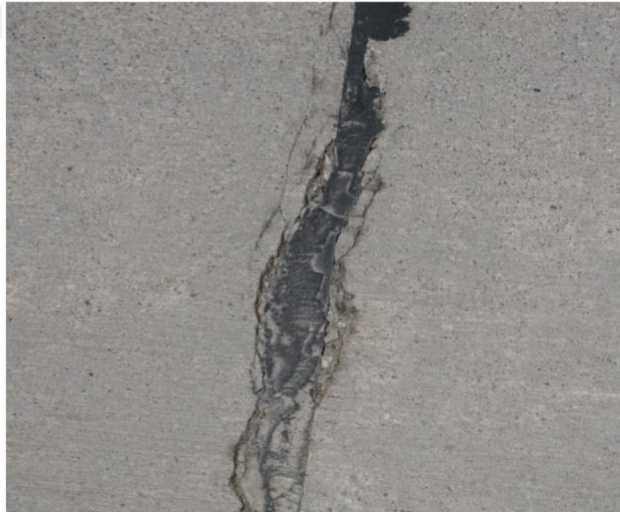
Şekil 3.29 : Çatlama artışı ile beton formundaki değişim.
