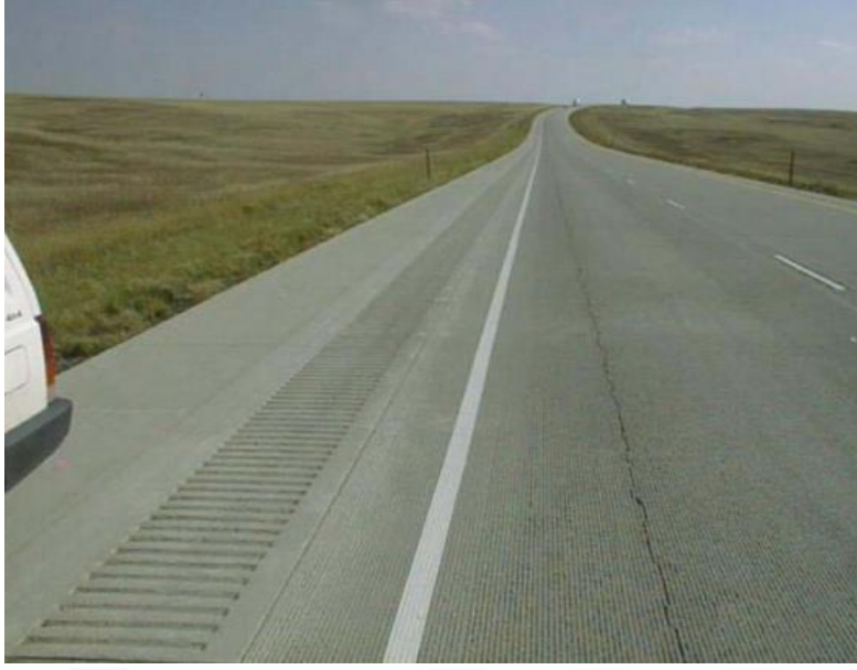
Şekil 3.25 : Beton yolda oluşan gelişigüzel boyuna çatlaklar.
