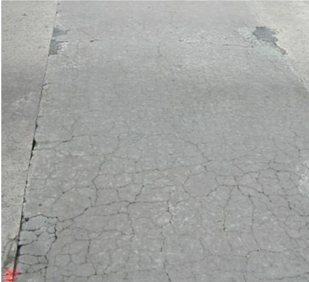
Şekil 3.23 : Beton yoldaki yüzey çatlakları.
