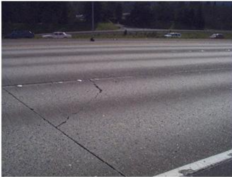
Şekil 3.26 : Beton yoldaki köşe kırılmaları.
