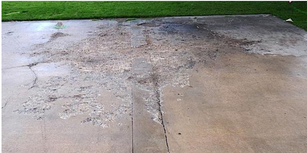
Şekil 3.21 : Buz çözücü tuzların kullanımı sebebiyle pullanmış bir beton yüzeyi.
