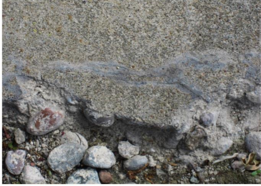
Şekil 3.32 : Çatlaklarda kalsiyum hidroksit ve kalsiyum karbonat sızıntısı.
