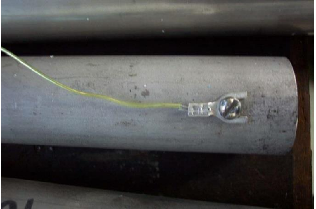
Şekil 4.8 : Elektrik bağlantılarının demirin yanında yapılması [33].
