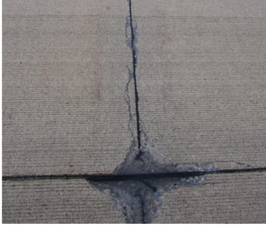
Şekil 3.28 : Gölgeleme sonrası derzde oluşan çatlak.
