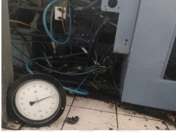
Şekil 6.15. Hava kaçakları nedeniyle basınç düşüşünün hassas manometre ile tespiti
