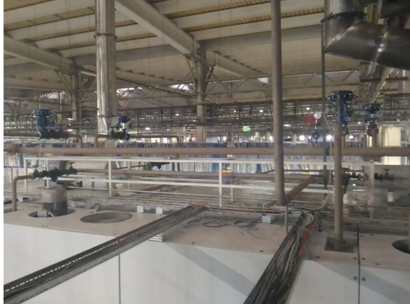
Şekil 6.2. Kurutma kabini üzerindeki buhar ve kondens hatlarının yalıtımsız hali
