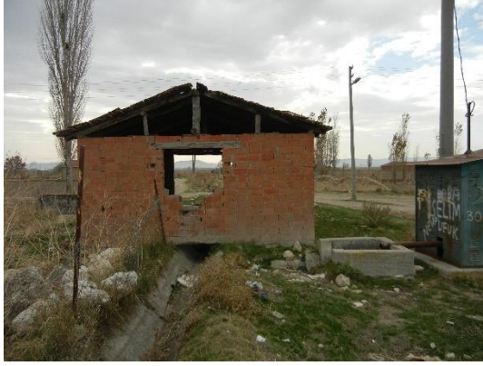
Şekil 4.49. Bozan Köyü sakanasının su kuyusunun pompa odası ve sakana içerisinden geçen su kanalı.
