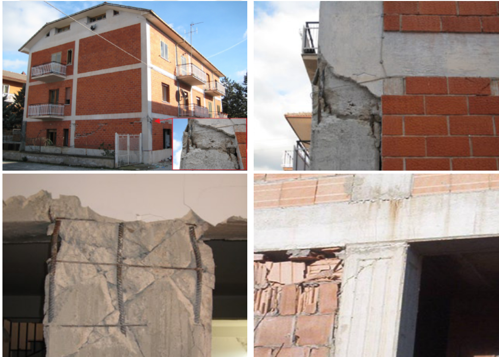
Görsel 7.1. Ditomaso vd., (2013)'e göre hasarlı binalar
