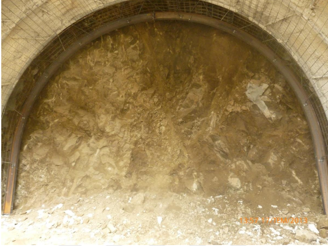
Şekil 3.8. Seyfe formasyonuna ait tünel aynasında gözlenen gelişli güzel eklemler
