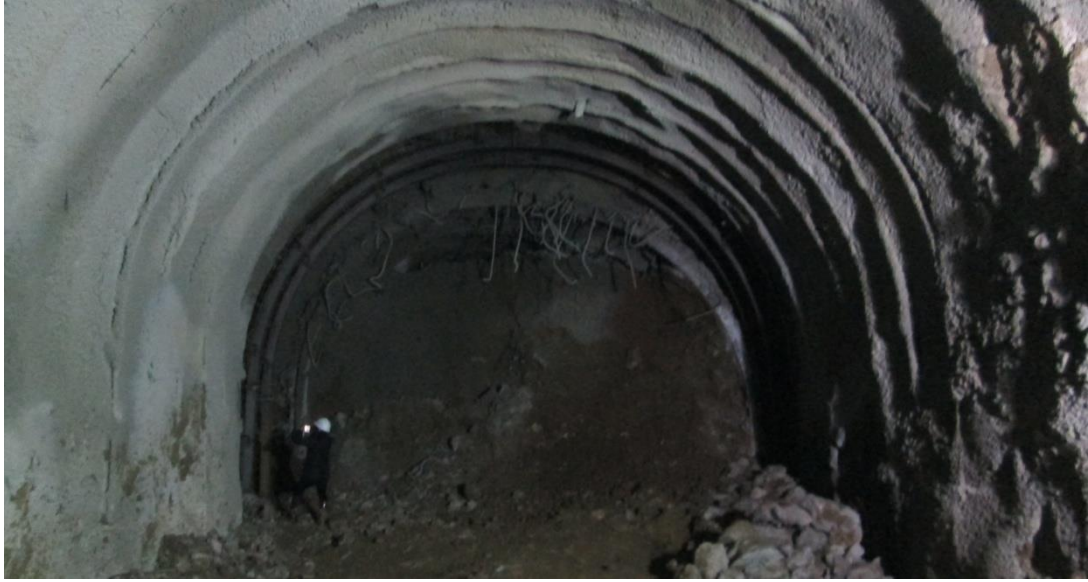
Şekil 5.16. Deformasyon bölgesinin gözlemi ve destek sisteminin incelenmesi
