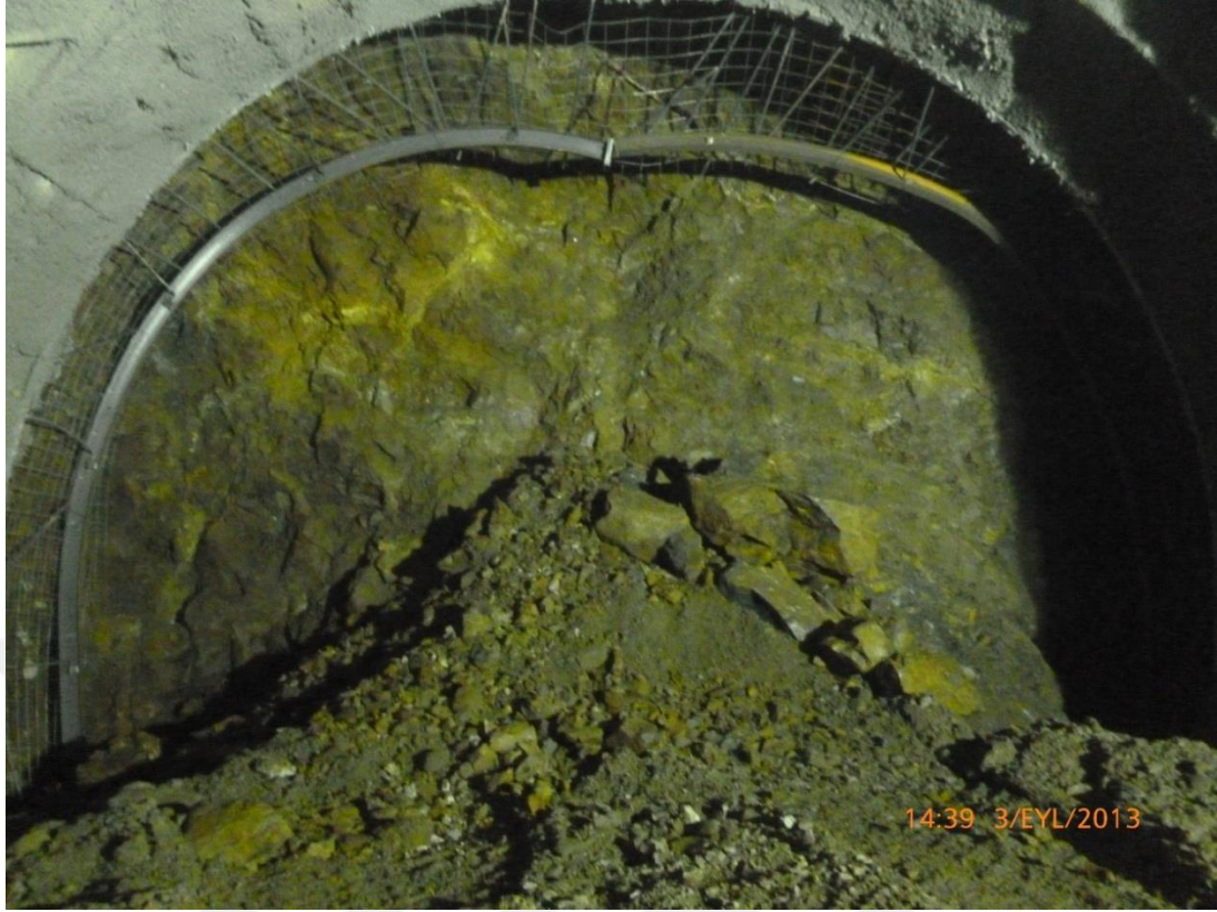
Şekil 5.10. Derivasyon tüneli ilk kazı sırasında deformasyon bölgesinde yaşanan hasar durumunun görünümü
