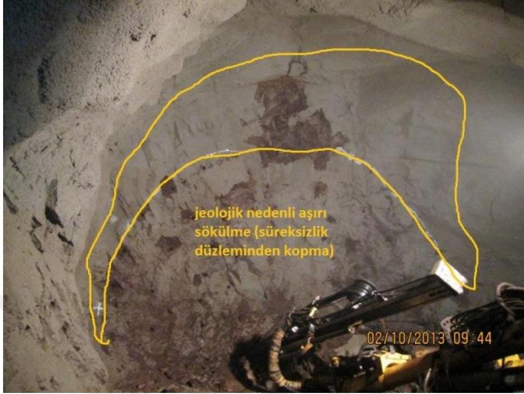
Şekil 4.5. Derivasyon tüneli güzergahında gözlenen zayıflık düzlemlerine ilişkin aşırı sökülmeler
