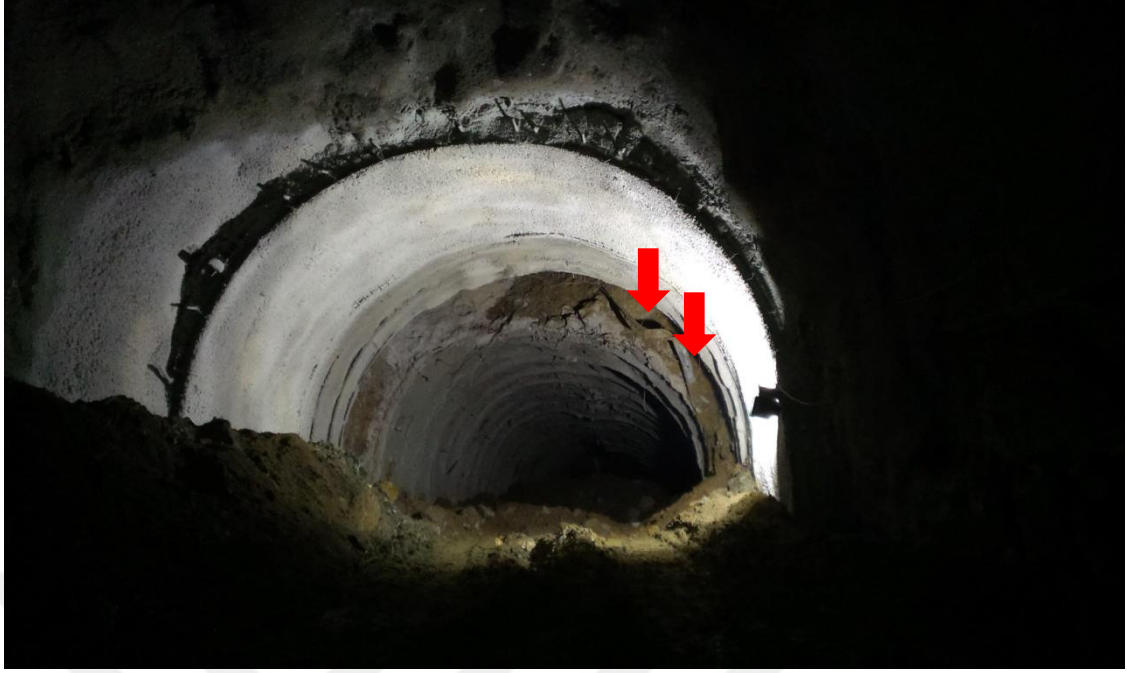
Şekil 5.11. Derivasyon tüneli kazı tamamlandıktan sonra deformasyonun meydana gelmesi
