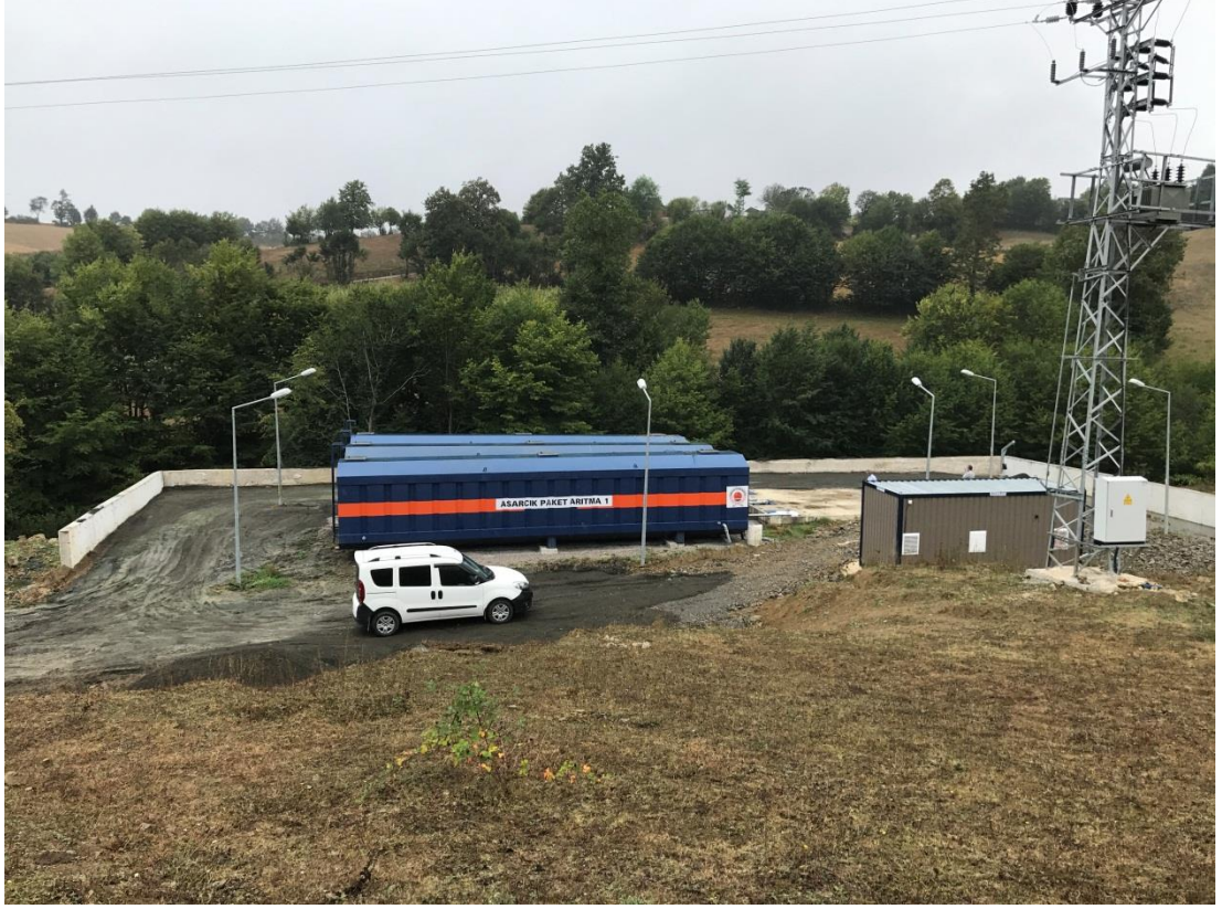
řekil 67: Asarcık Paket Arıtma Tesisi.
