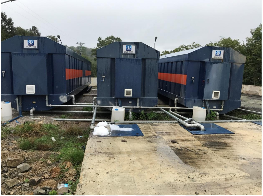
Şekil 68: Asarcık Paket Arıtma Tesisi.
