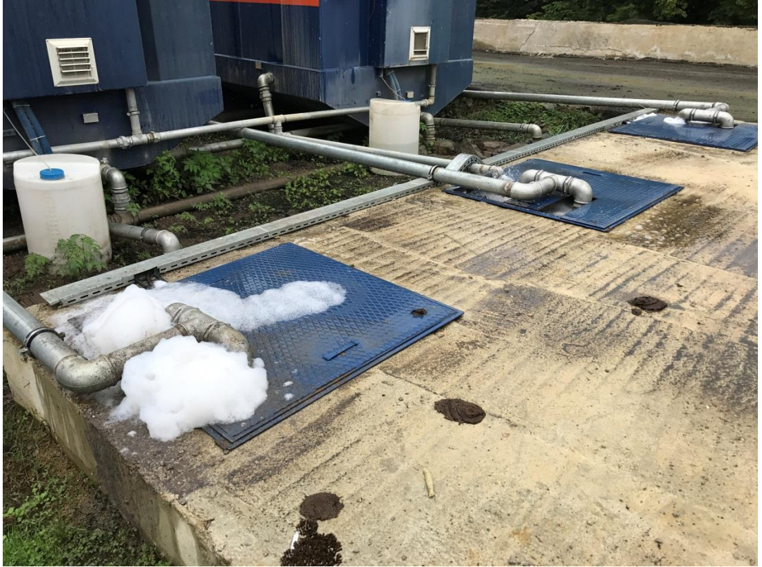
Şekil 69: Asarcık Paket Arıtma Tesisi.
