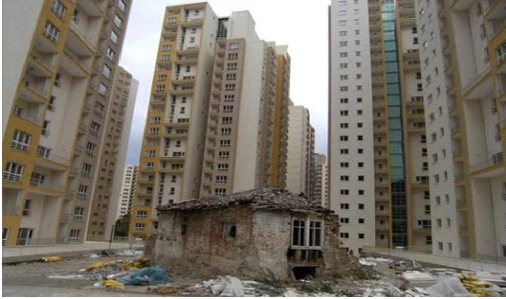
Şekil 5.16 : Bloklar arası yıkımı henüz tamamlanmayan bir bina.
