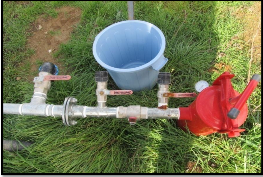
Şekil 3.5. Sulama sistemi, filtre ve gübreleme ünitesi
