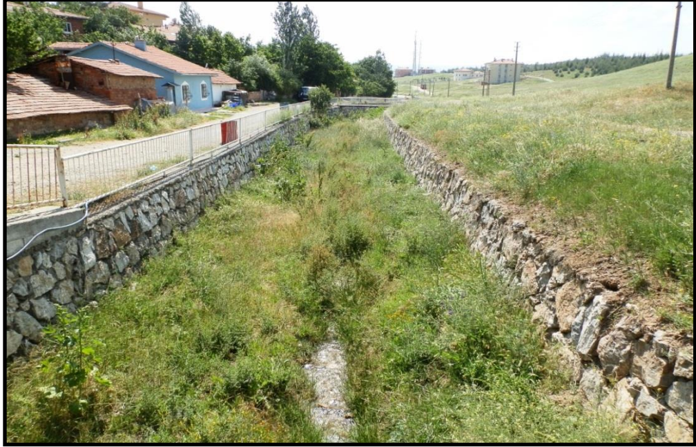
Foto 40 : Çorum Merkez Nadık Deresi'nde Taşkın Kontrol Duvarı
