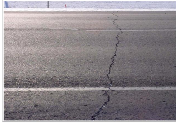
Şekil 2.34. Yüksek şiddette enine çatlak (İsfalt, 2002).
