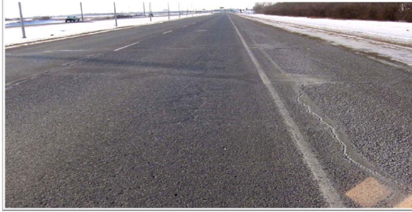
Şekil 2.33. Orta şiddette kenar çatlağı (İsfalt, 2002).
