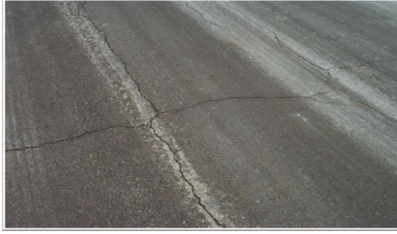
Şekil 2.36. Orta şiddetli blok çatlaklar (İsfalt, 2002).
