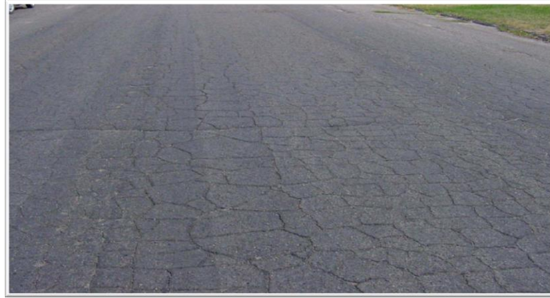
Şekil 2.37. Yüksek şiddetli blok çatlaklar (İsfalt, 2002).
