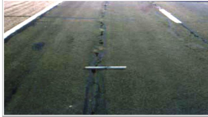
Şekil 2.35. Yüksek şiddette boyuna çatlak (İsfalt, 2002).
