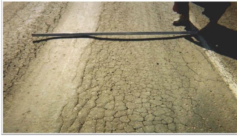
Şekil 2.31. Orta şiddette timsah sırtı çatlak (İsfalt, 2002).
