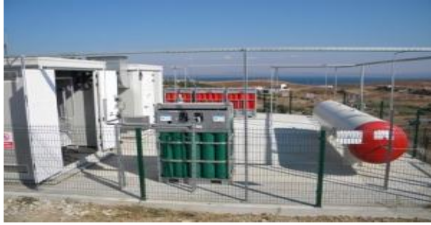
Şekil 2.24 Bozcaada'da Kurulan Hidrojen Enerji Üretim Tesisi
