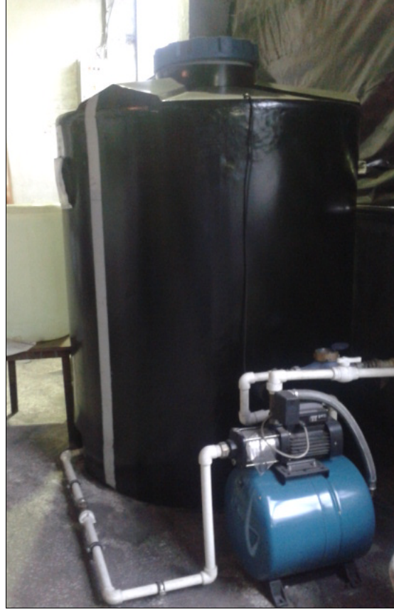
Şekil 3.11. Arı su deposu ve hidrofor.
