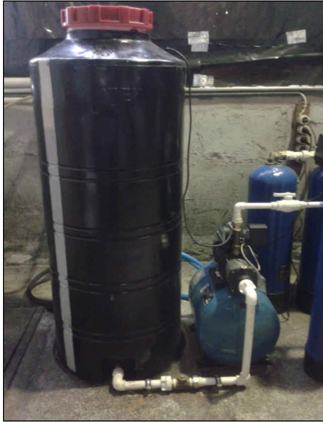
Şekil 3.8. Ham su deposu ve hidrofor.
