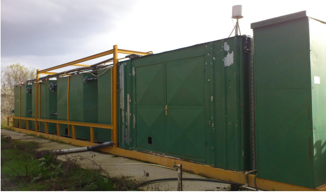
Şekil 3.1. Biyogaz Tesisinin Görünümü
