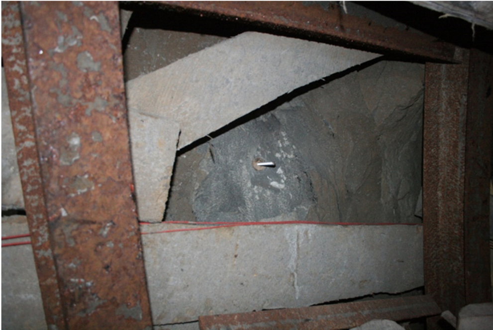
Şekil 6.17 Galeri yan duvarına monte edilmiş ahşap takoz ve metal saplama.
