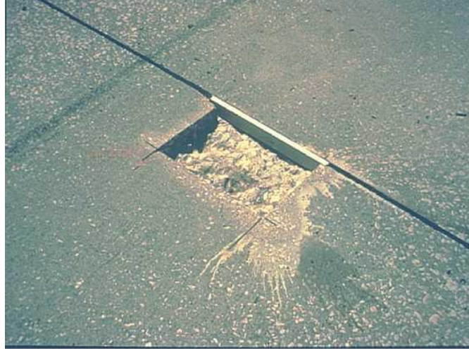
Şekil 4.24 : Derz çatlağı ve tamiri.
