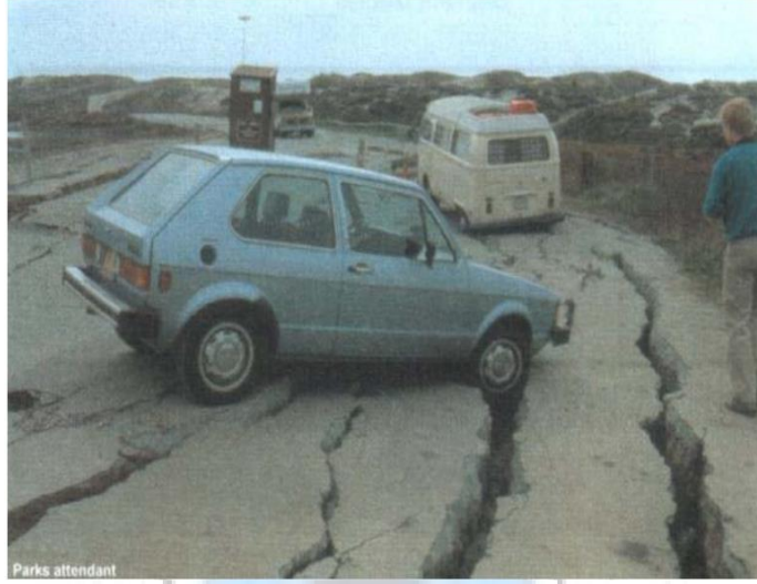
Şekil 2.13 1989 Loma Prietadepreminde devlet parkı yakınında oluşan yanal yayılma (Mollamahmutođlu ve Babuđucu 2006).
