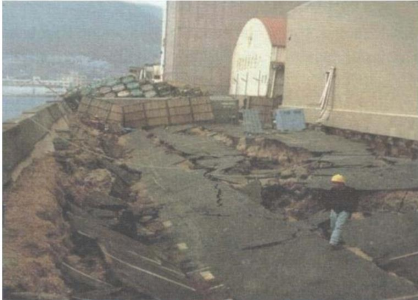
Şekil 2.14 1995 Kobe depreminde sıvılařma sonucu oluřan istinat duvarı yenilmesi (Mollamahmutođlu ve Babuđucu 2006).
