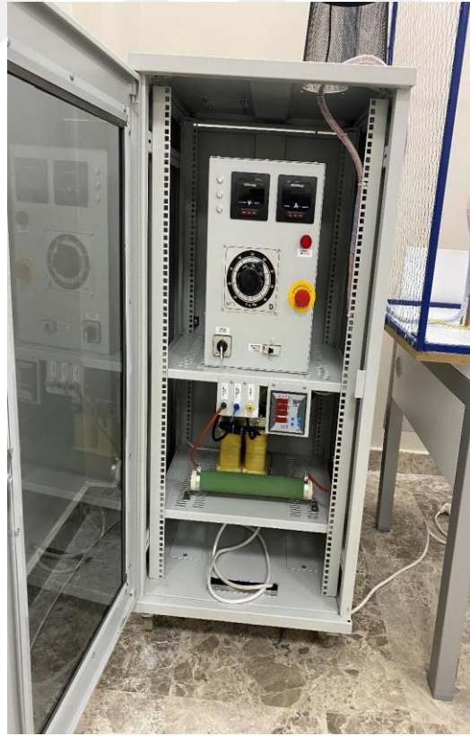
Şekil 3.16: Trafo, varyak ve dirençten oluşan deney panosunun görüntüsü.
