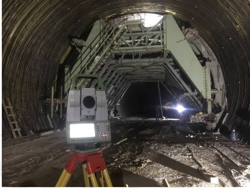
Őekil 3.30. Tnel i kaplama (kemer) beton kalıbı (Ankara-Sivas Demiryolu Projesi T-15 Tneli).
