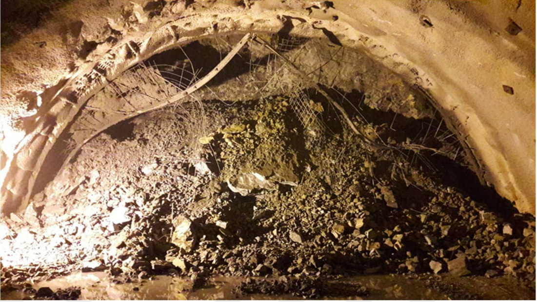
Şekil 4.34. Tünel-15 Çıkış Km:57+692.50'de oluşan göçük.
