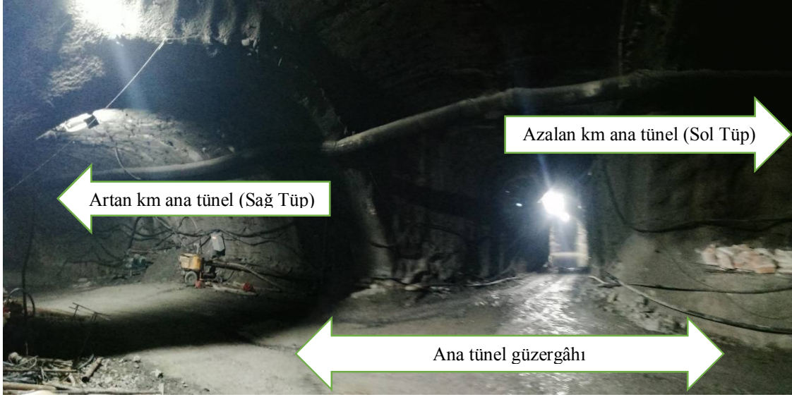
Şekil 4.7. Güvenlik-2 Tüneli içerisinde ana tünel çalışmalarını hızlandırmak için açılmış olan, Sağ ve Sol Tüp olarak adlandırılan iki yeni tünel ağzının oluşturulduğu T bölgesi.
